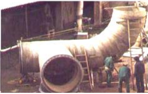
Figura 2.6 – Tubulação em P.R.F.V.
