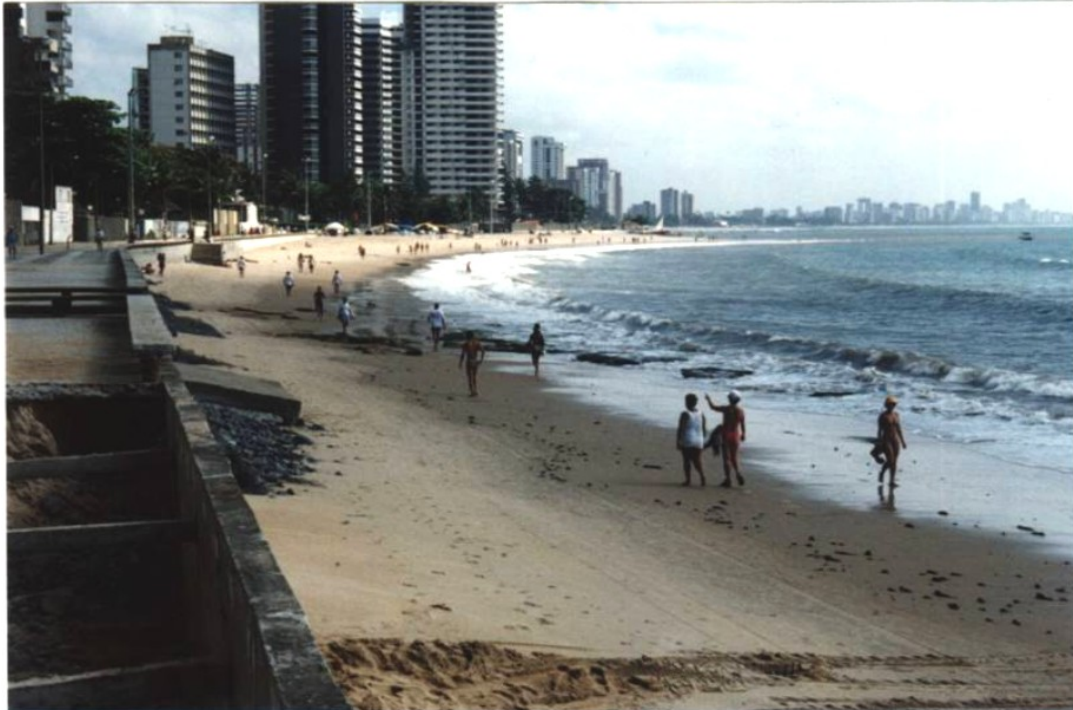
Foto 10 – Exemplo de obra mal sucedida, na Célula 5 (praia das Candeias), no qual um “seawall” associado a rampas de acesso, ocupando a pós-praia e parte do estirâncio, apresenta destruição parcial, agravada pela retirada de areia de sua base, necessitando de pequenos enrocamentos para sua proteção.
