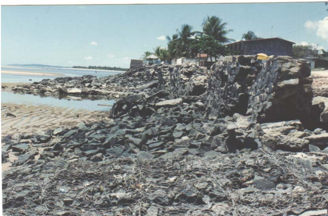
Foto 19 – Detalhe de enrocamentos associados a gabiões, na praia das Candeias a sul do restaurante Candelária, demonstrando a ineficiência deste tipo de obra.
