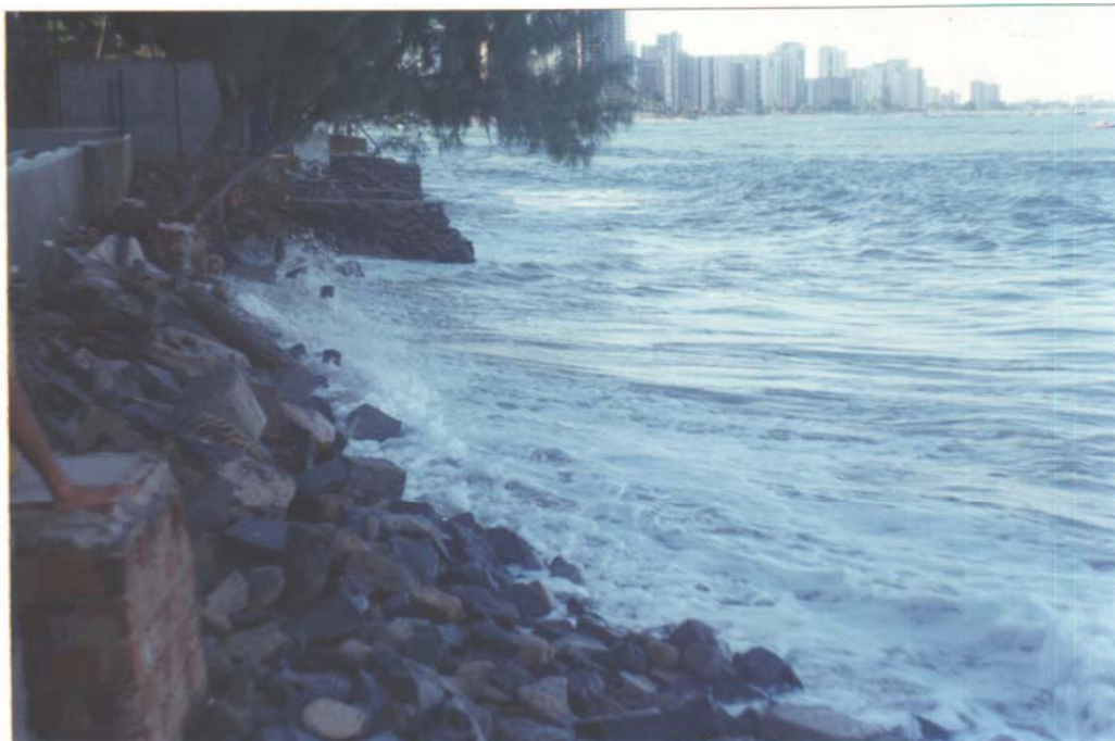
Foto 9 – Enrocamento destruído pela ação direta das ondas de preamar.
