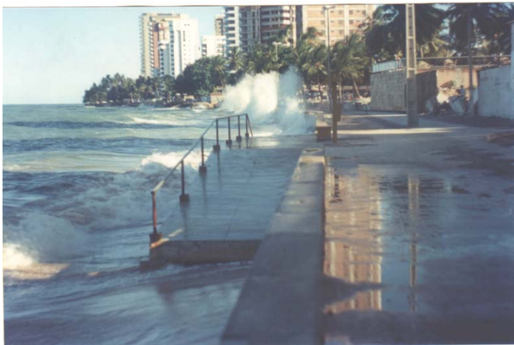
Foto 12 – Outro trecho da Célula 5, com incidência frontal das ondas e arrebenção direta no “seawall”. Em primeiro plano, vê-se a retirada de sedimentos sob a rampa devido à percolação das águas.
