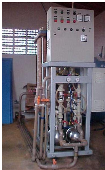
Figura 3.9 – Modelo de dessalinizador instalado em Pernambuco.
