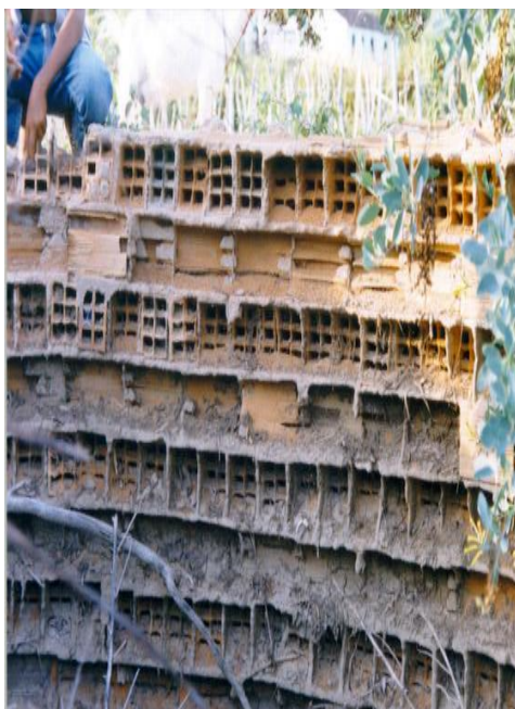
Figura 6.18 - Corrosão na parede de tijolos provocada pela água salinizada.
