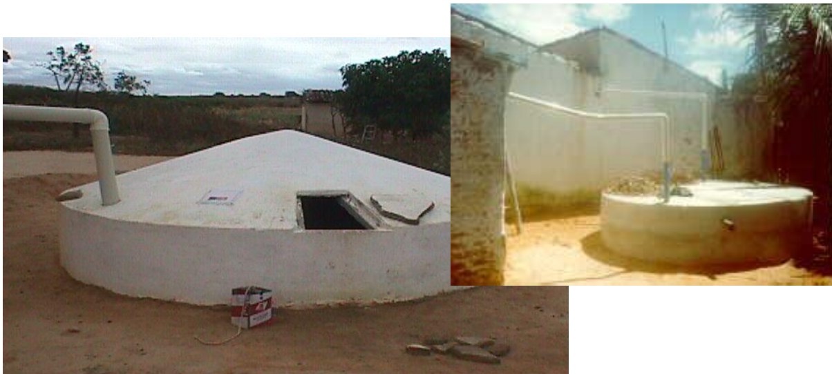
Figura 3.2 - Cisternas para captação da água do telhado.
