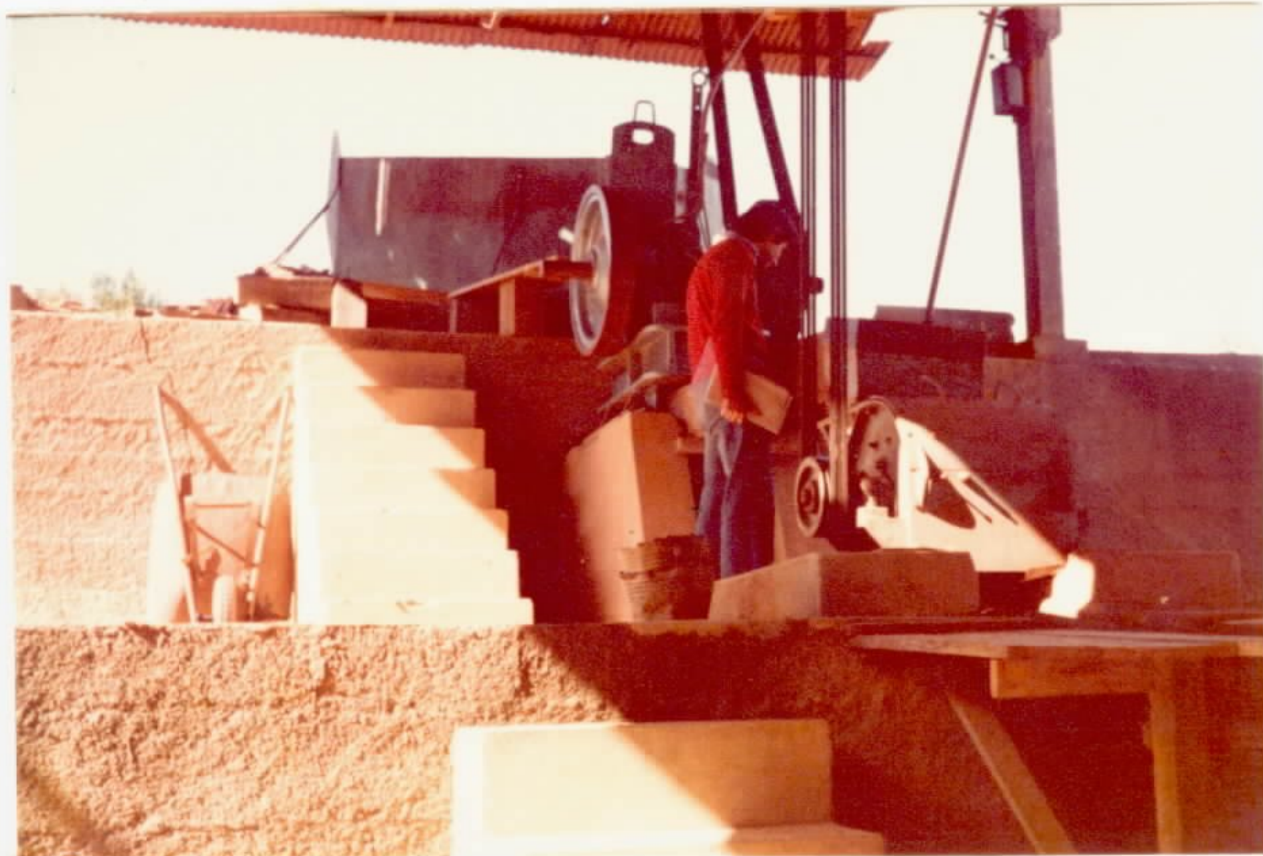
FOTO 9 - Instalações de beneficiamento. Ao fundo britador de mandíbula e próximo ao técnico, moinho de martelo.
