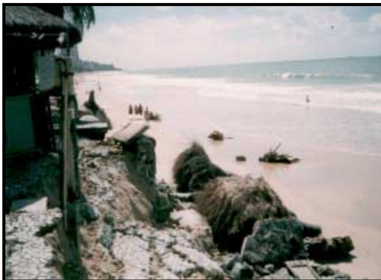
Foto 6 - Destrução provocada pela ressaca do mar em Boa Viagem - 1995.
