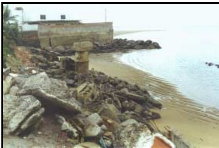
Foto 8 - Restos de construções destruídas pela ressaca no bairro de Barra de Jangada.
