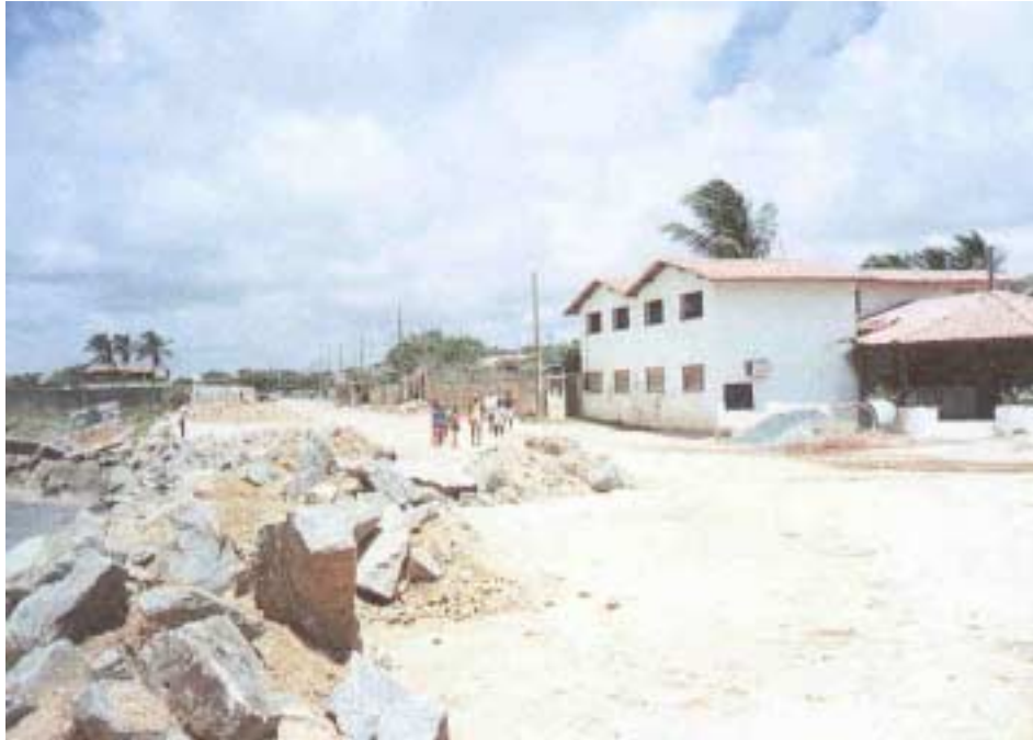
Foto 11 – Erosão em Barra de Jangada
