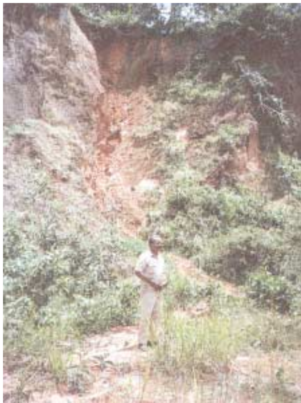
Foto 8 – Erosão às margens da rodovia BR - 232
