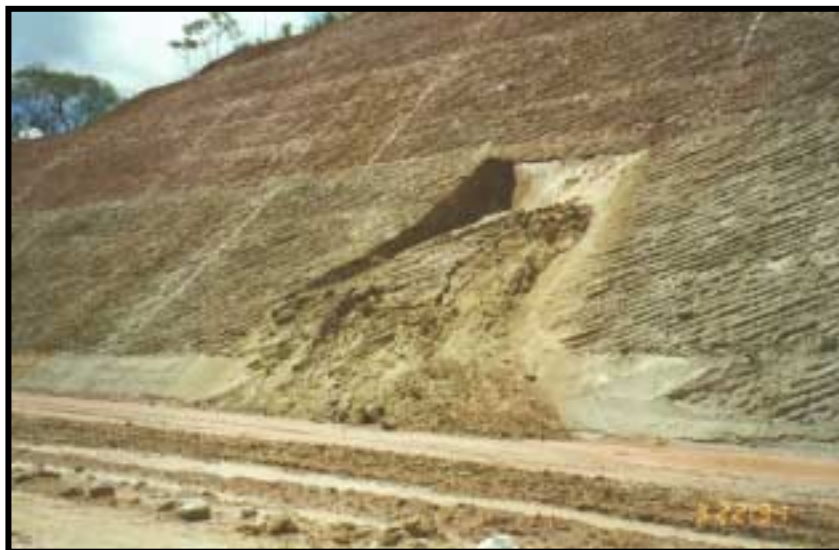
Foto 15 - Deslizamento em talude artificial. (Corte às margens da rodovia BR-101).
