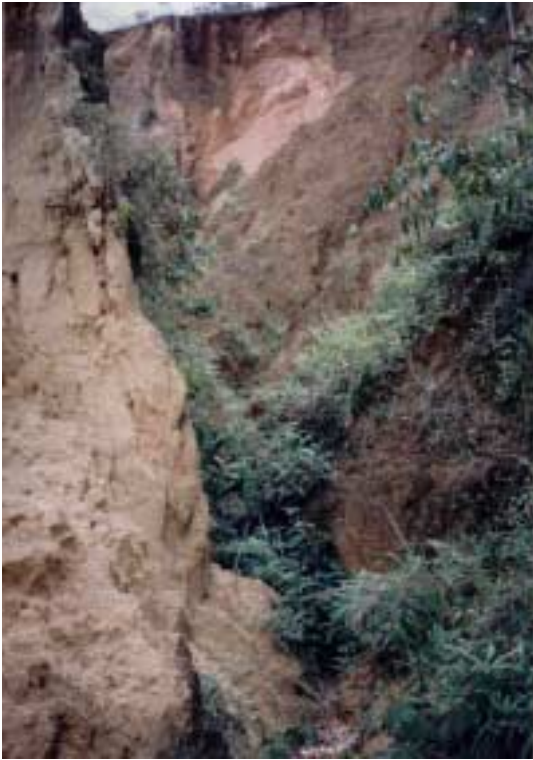
Erosão às Margens da BR 232
