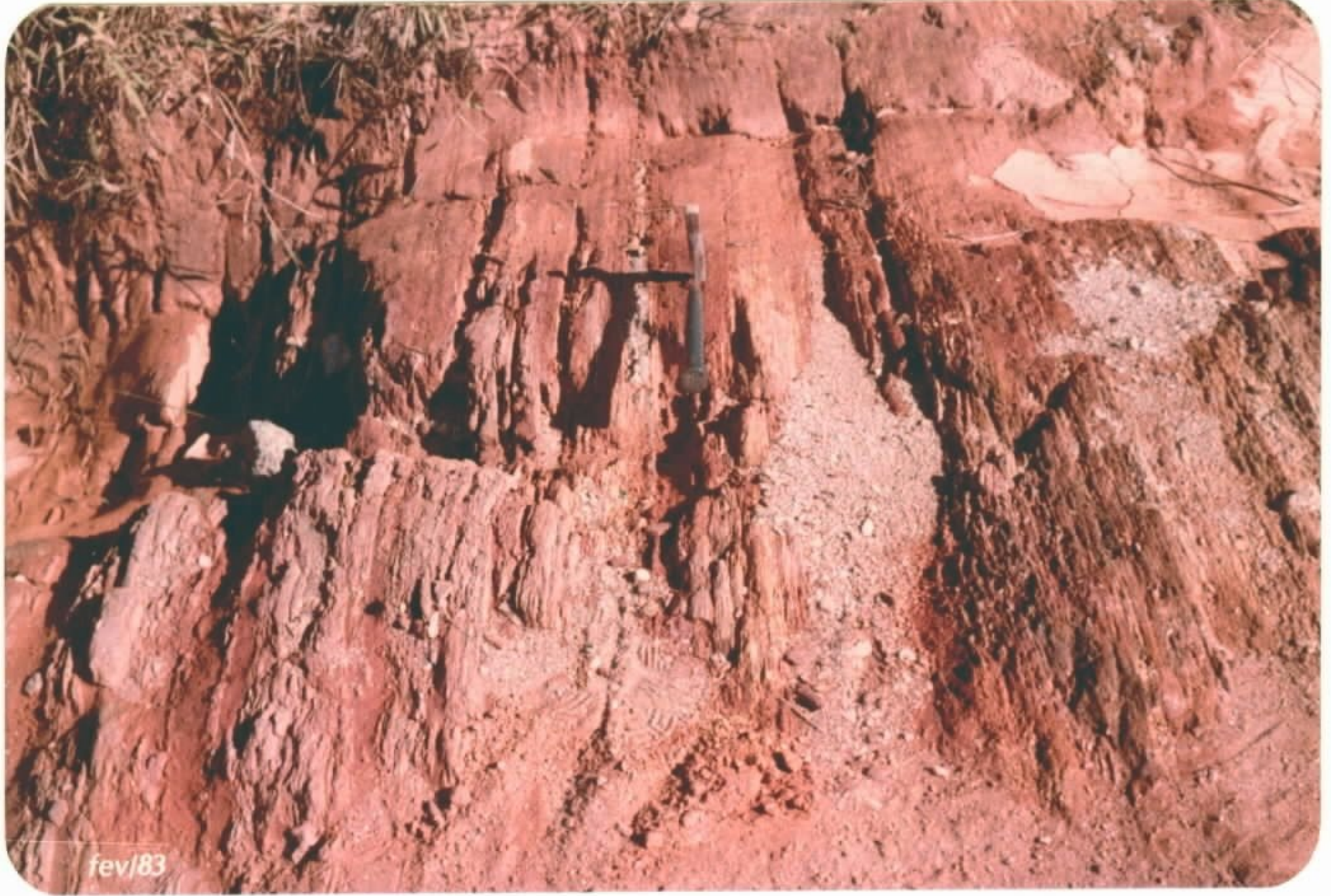
roche de zone de faille
