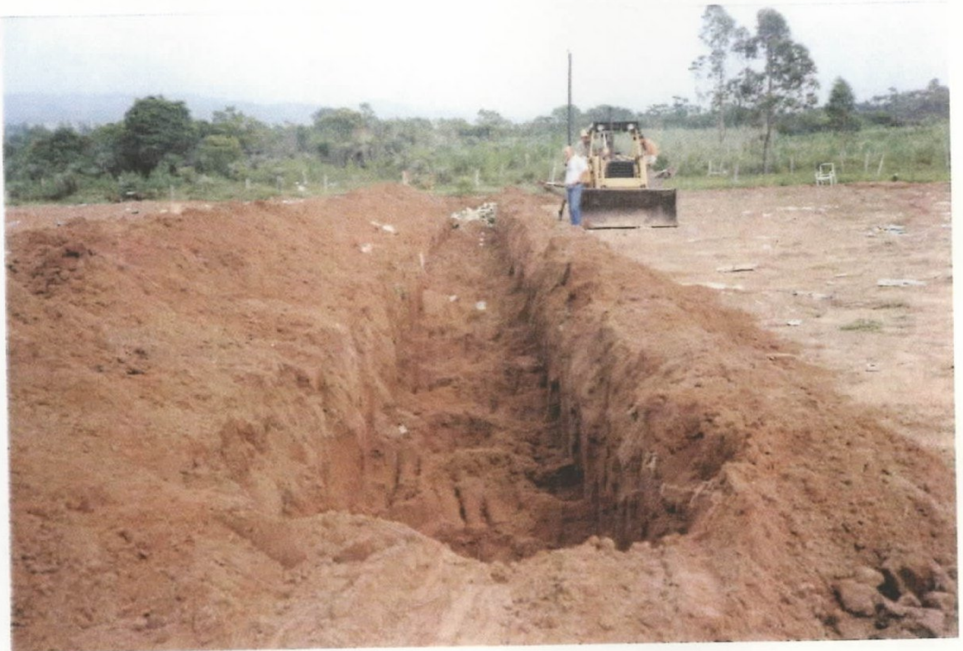
Foto 12 - Aterro controlado em valas, com cobertura diária, em Torres. Condição de operação razoável.
