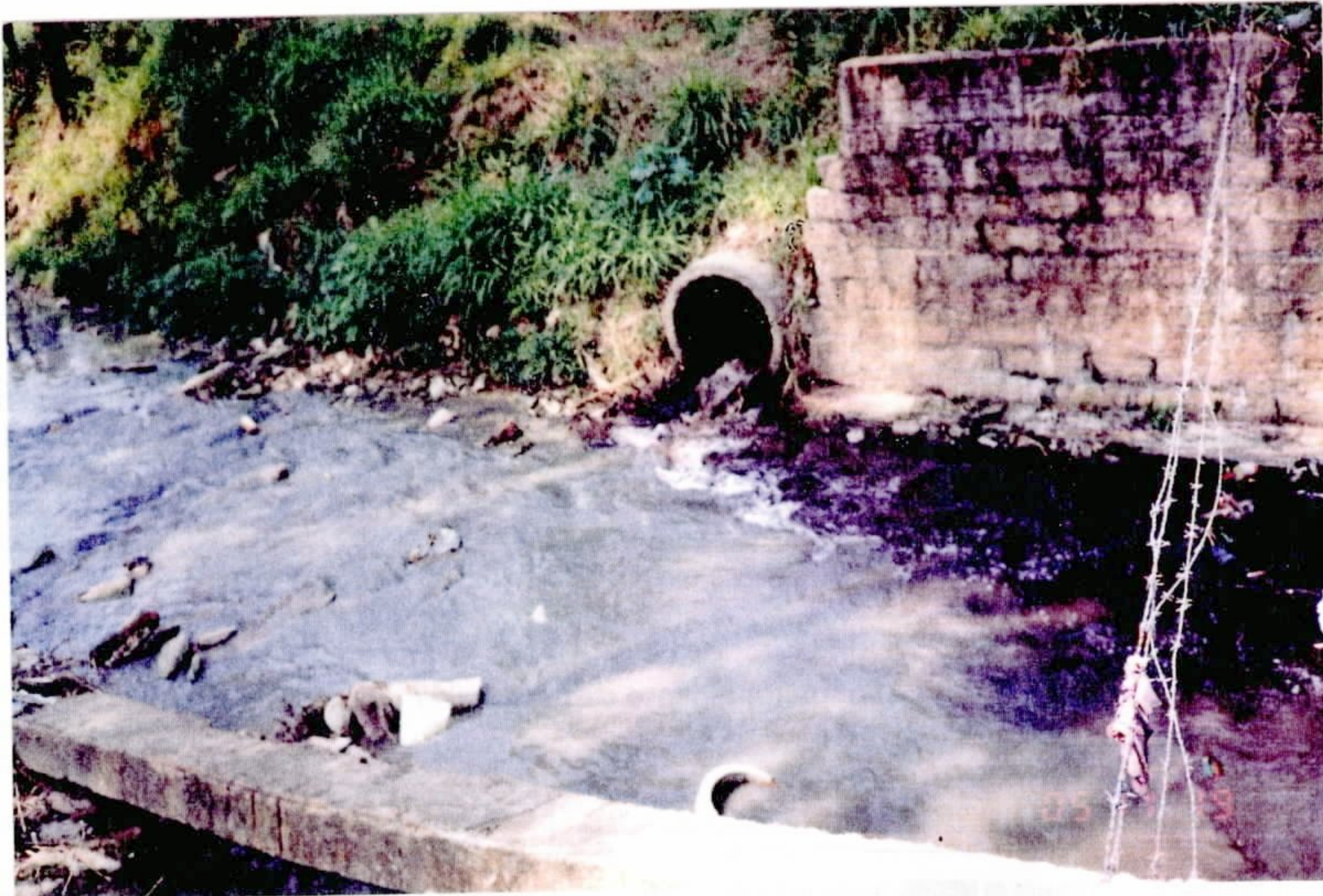
Foto 1 - Intensa contribuição de despejos domésticos, comerciais e industriais. Ponte sobre o rio Criciúma na rua Domênico Sônego.
