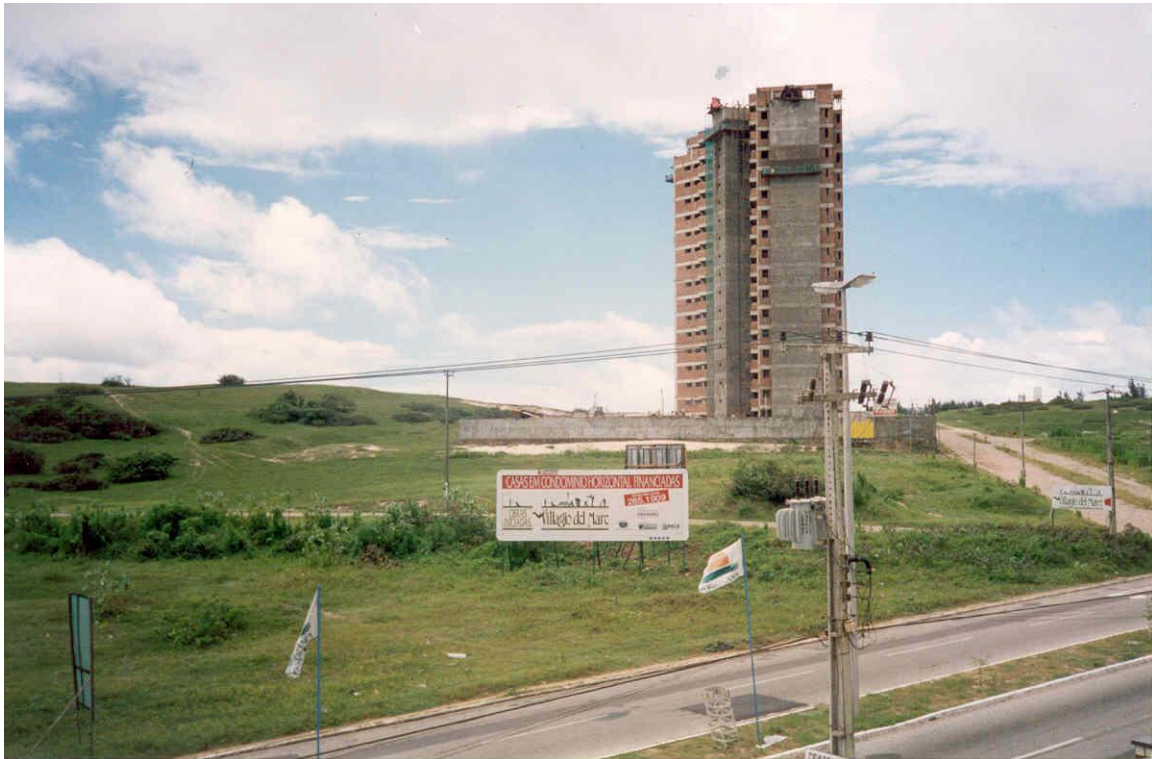
Fotos 1 e 2: Ocupação inadequada em áreas de dunas. Praia do Futuro, Fortaleza.
