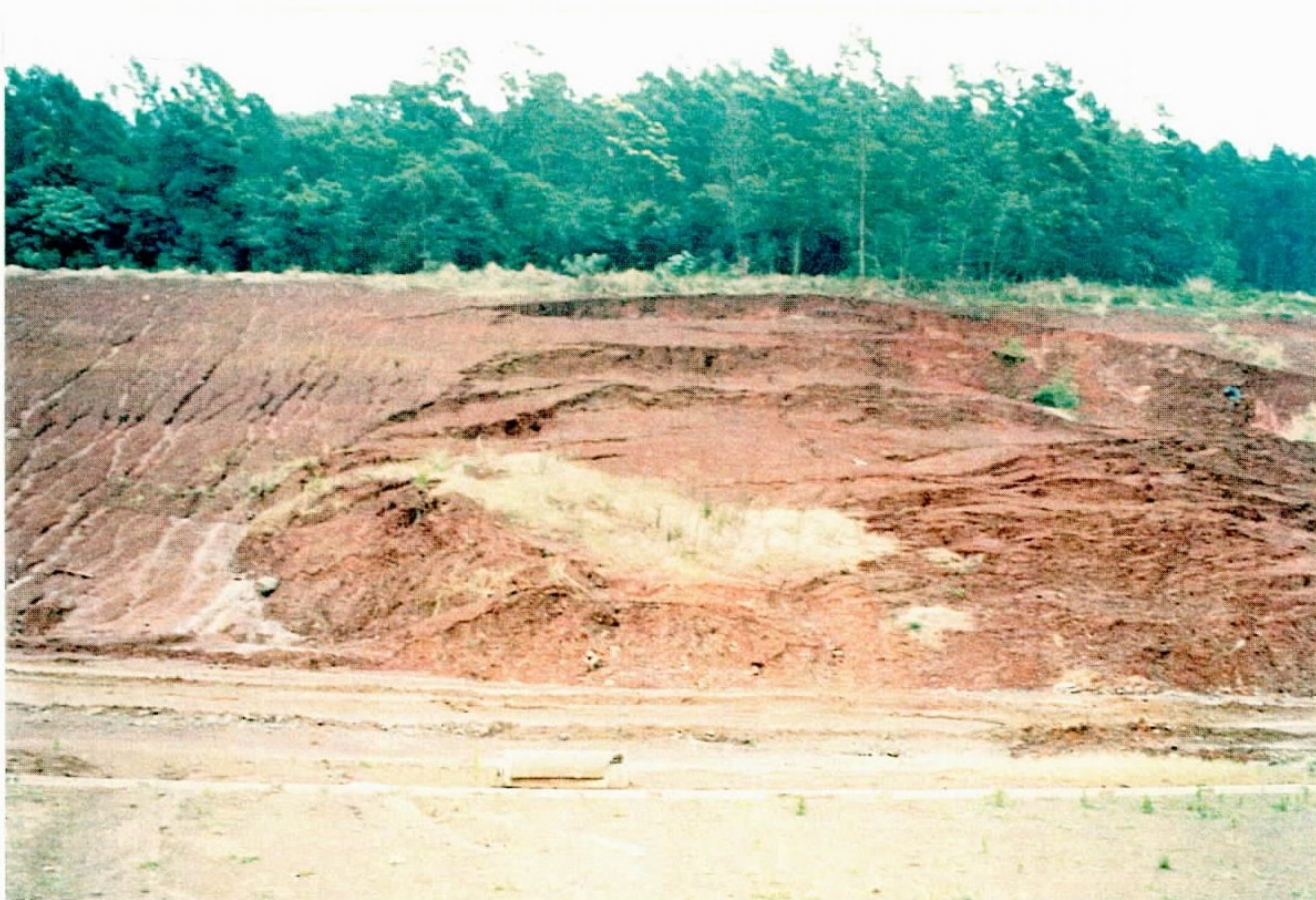
Foto 8 - Escorregamento de uma cunha de solo onde o mergulho regional das camadas favorece o escorregamento, ocorrido durante chuvas intensas. Corte de talude nas proximidades da estação de tratamento da indústria Bender/Schuck.
