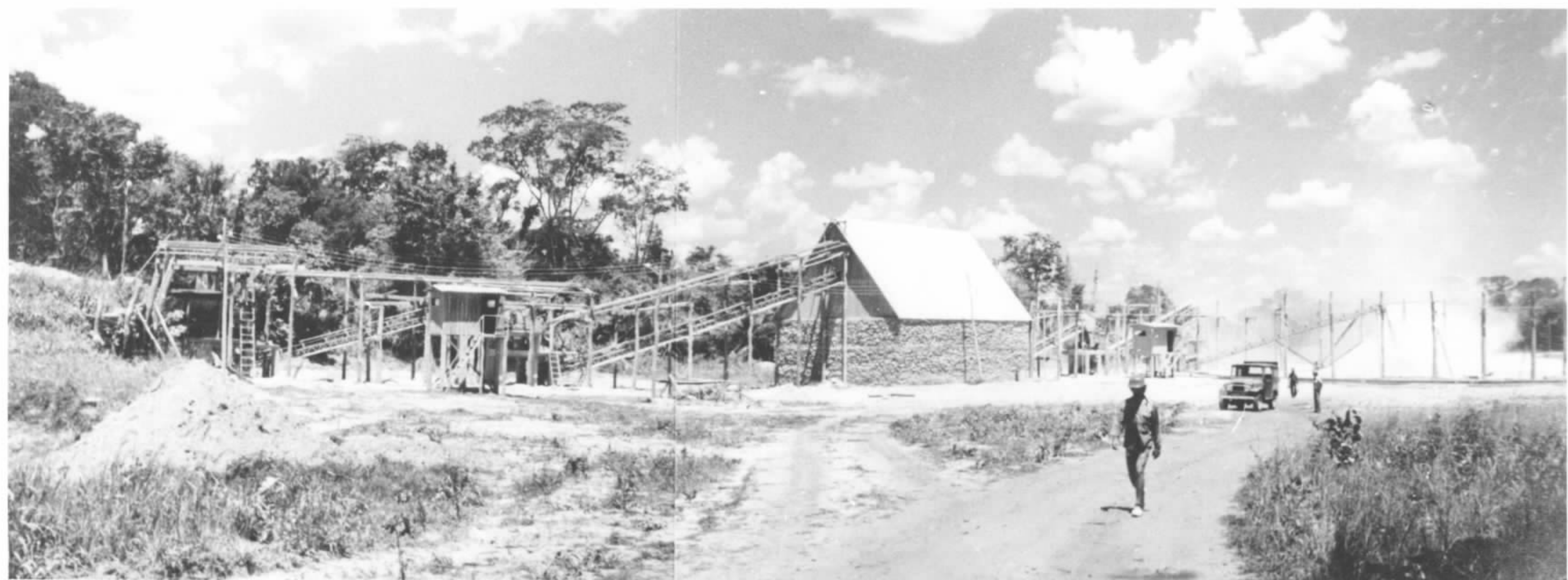
FOTO 05 — Vista geral das instalações de moagem da Calcário Bonito Ltda., situadas próximo à cidade de Bonito. Acha-se em plena atividade, sendo uma das pequenas indústrias que melhores perspectivas apresentam. Produz, atualmente, cerca de 3.500 ton./mês de pó calcário, vendidas, na usina, ao preço de Cr$ 110,00/ton.
