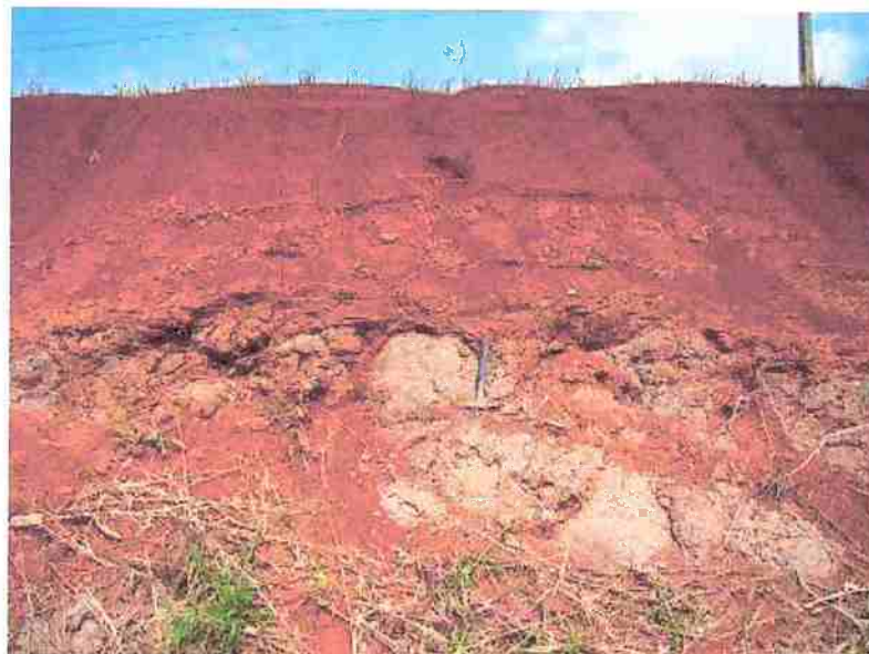
Foto 2.38: Perfil com solo residual na base e transportado no topo, delimitados por uma linha de seixos. Matérias de características geotécnicas bem diferentes. Possível ver os sulcos causados por erosão hídrica nas argilas expansivas que recobrem a parte superior. Proximidades de Quatro Pontes.
