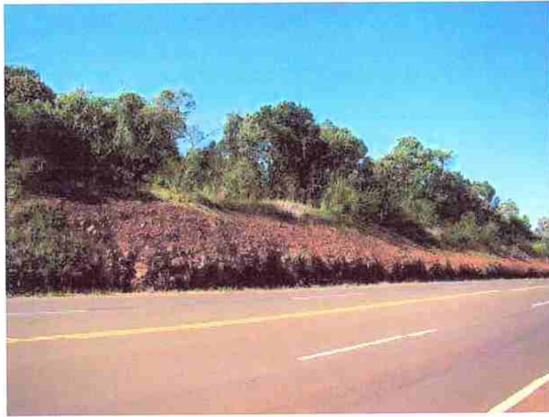
Foto 2.9: Corte de estrada com perfil de solo coluvionar. É possível observar processos erosivos e desmoronamentos decorrentes da presença de argilas expansivas. Estrada RP12 entre Puerto Esperanza e Puerto Mado, Misiones, Argentina.
