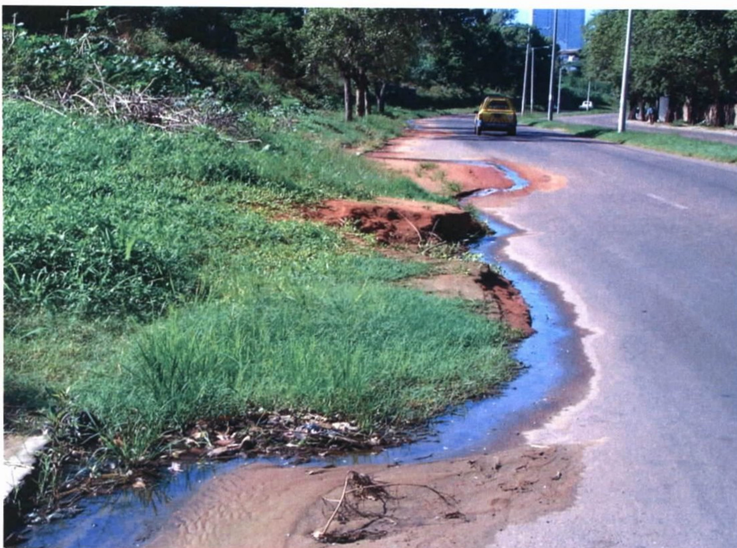
Fotografia 12 - Evidência de obstrução de uma via de acesso.
