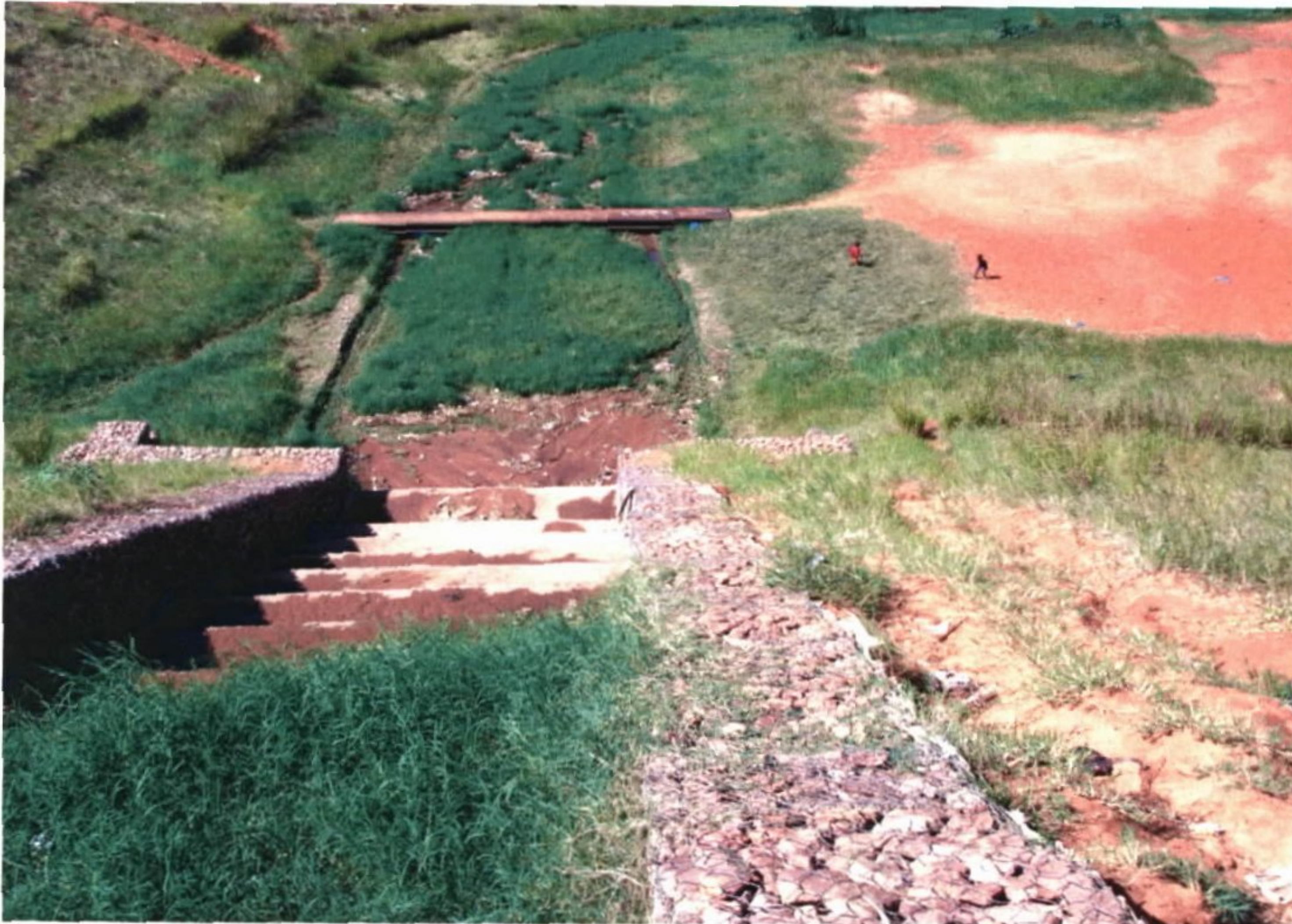
Fotografia 9 - Estrutura para escoamento de águas pluviais
