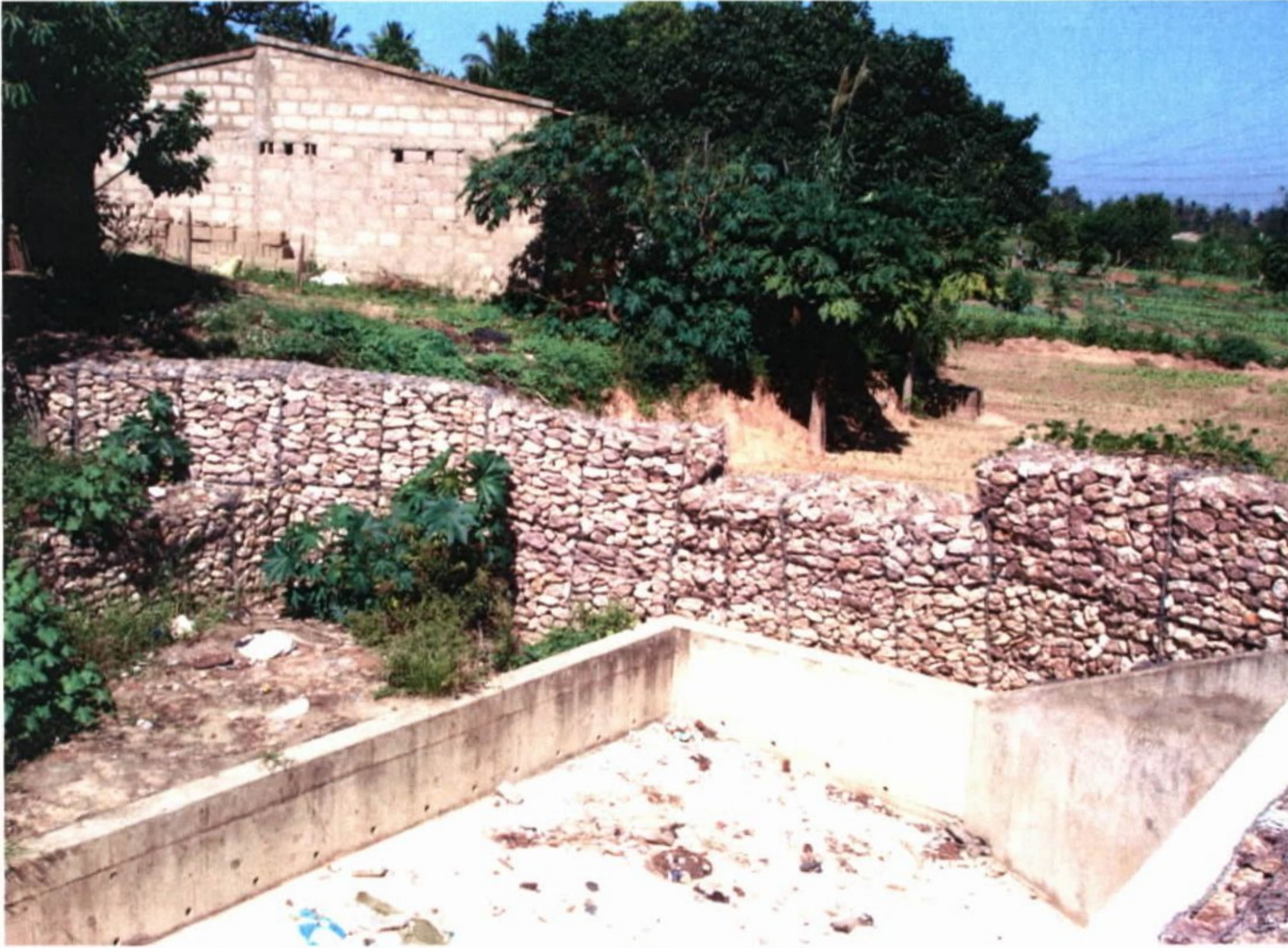
Fotografia 5 - Vertedor construído com gabiões para escoamento da água nas enchentes
