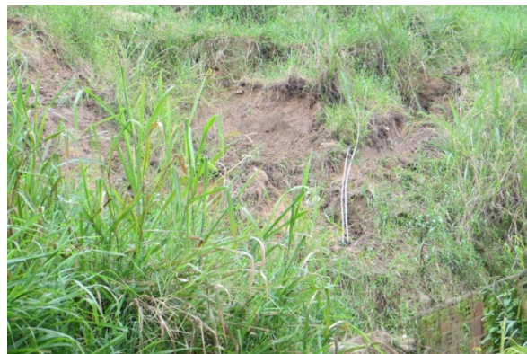
Ruptura parcial de trecho da encosta, com exposição de tubos de 25mm
