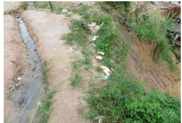
A calha escavada no terreno garante a permanente infiltração das águas servidas na crista do talude
