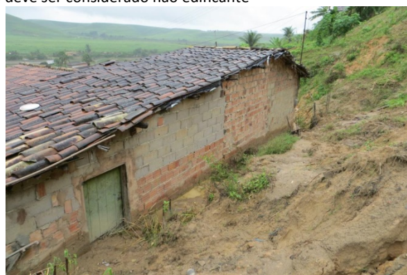
Escorregamento com soterramento parcial do imóvel: local de instabilidade e Alto Risco de novas ocorrências
