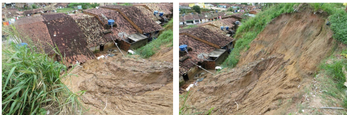
Ruptura de aterro de crista ocasionado pelo fluxo de águas pluviais concentrados por variações do relevo e valas escavadas de forma improvisada.
