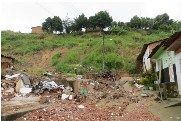
Base da encosta na Rua Sem Nome. Os escombros à esquerda, são da moradia destruída com óbito.
