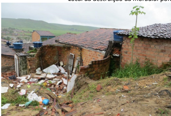
A destruição do imóvel afetou a moradia vizinha, provocando rachaduras nas paredes
