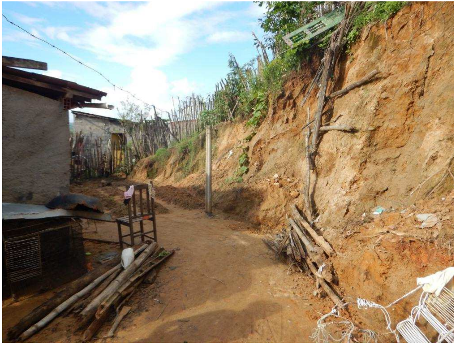
Foto 1 – Vista do talude próximo da casa. Neste trecho, o morador já havia retirado o material escorregado.
