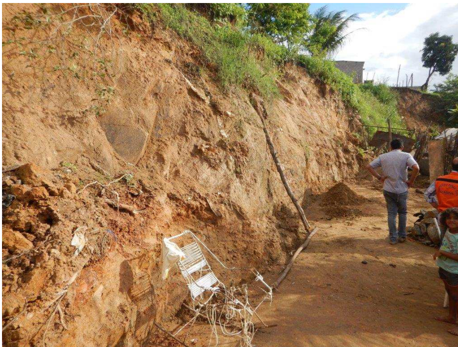
Foto 2 – Vista do talude próximo da casa. Notar trechos escavados pelo morador no pé do talude.
