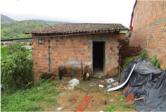
Parte posterior da casa vermelha: trincas de pequeno porte no terreno
