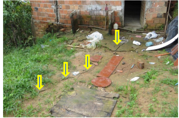
No detalhe: Trinca atravessando o terreno e rachando a calçada na parte posterior do imóvel
