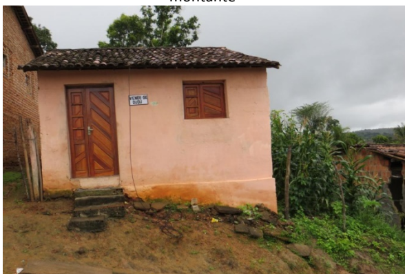
Casa situada no limite do contato com a trinca. Ainda não afetada, mas em Risco Remanescente Alto, até a realização de obras de contenção e drenagem no local
