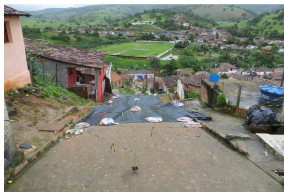
Final do calçamento na Rua Frei Caneca: lonas plásticas impermeabilizando o trecho afetado pela trinca para conter a evolução do processo
