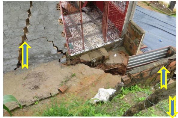
Rachaduras provocadas por efeito de torção na estrutura do imóvel, após a ruptura do terreno formando a trinca.
