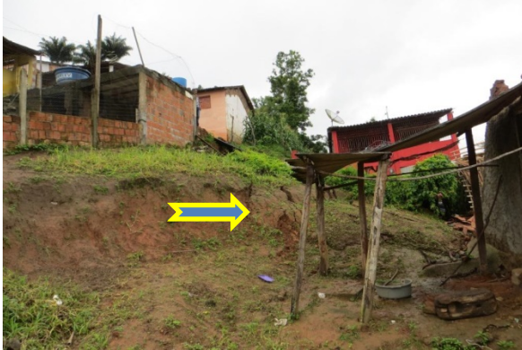
Continuação lateral da trinca, ao lado da casa totalmente destruída
