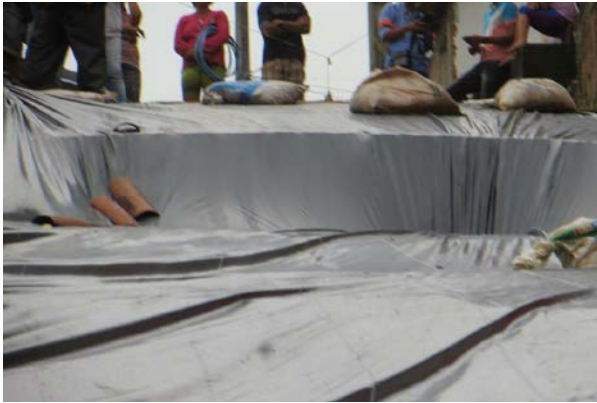
Rejeito vertical da trinca
