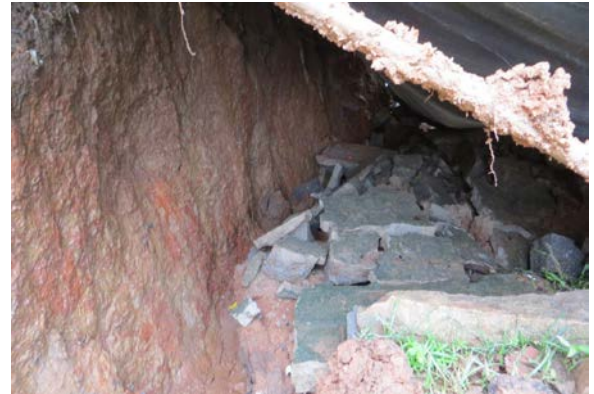
Detalhe da trinca: rejeito vertical e horizontal
