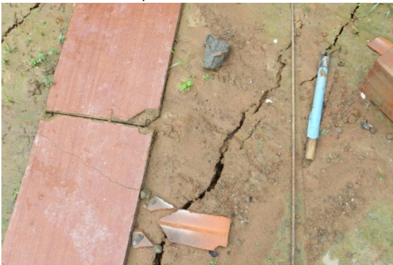
Trincas disseminadas no terreno, por influência do escorregamento
