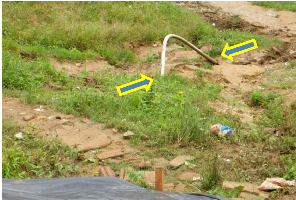
A compressão provocada pelo escorregamento solo sobre rocha provocou a deformação da tubulação adutora da rua
