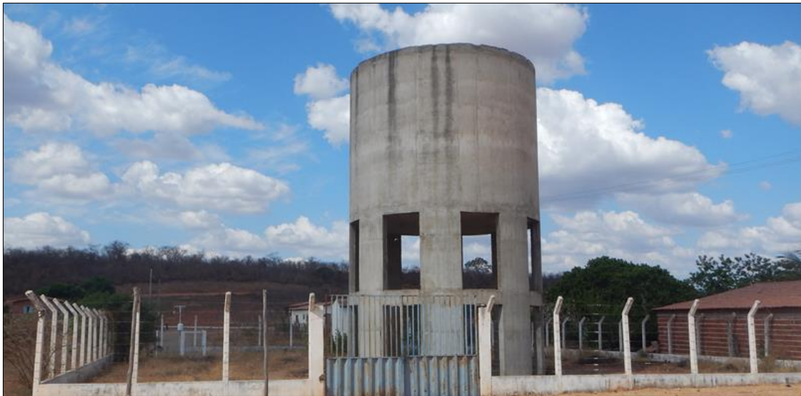
Foto 36: Vista geral do poço Bairro Valdir Leite na sede de Pedro Laurentino – PI.
