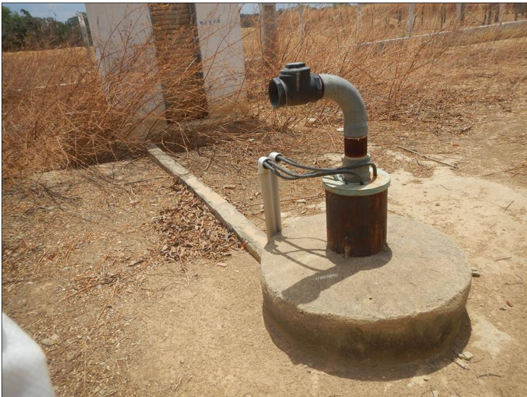
Foto 30: Poço, tubo de saída e instalação elétrica.
