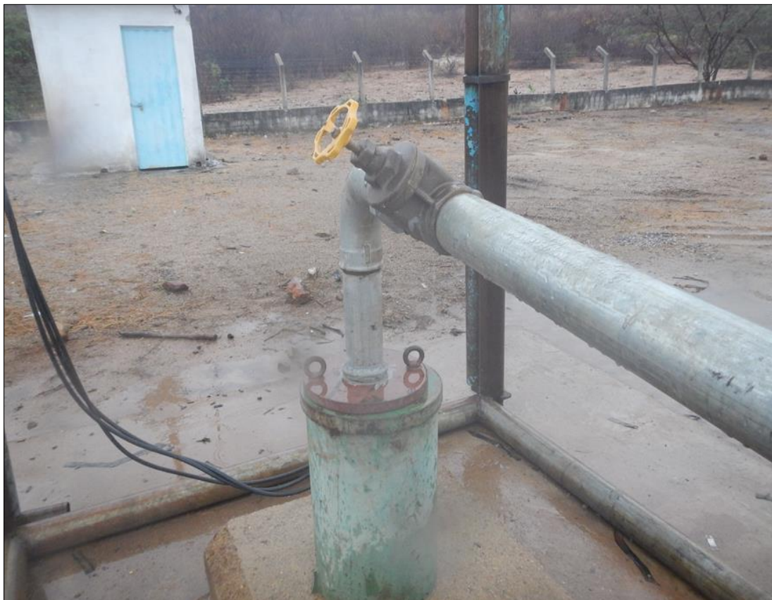
Foto 45: Detalhe do poço e tubulação para alimentação do reservatório.
