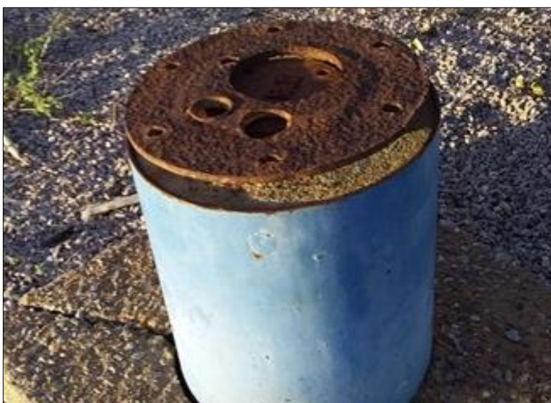
Foto 24: Tubo de revestimento do poço Sítio Ervanso mostrando
