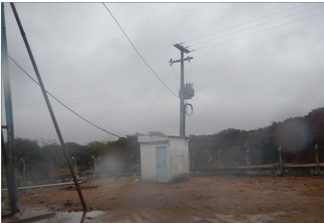
Foto 44: Transformador, fiação aérea para a bomba do poço e sistema de bombeamento para a adutora e casa do painel de controle da bomba.
