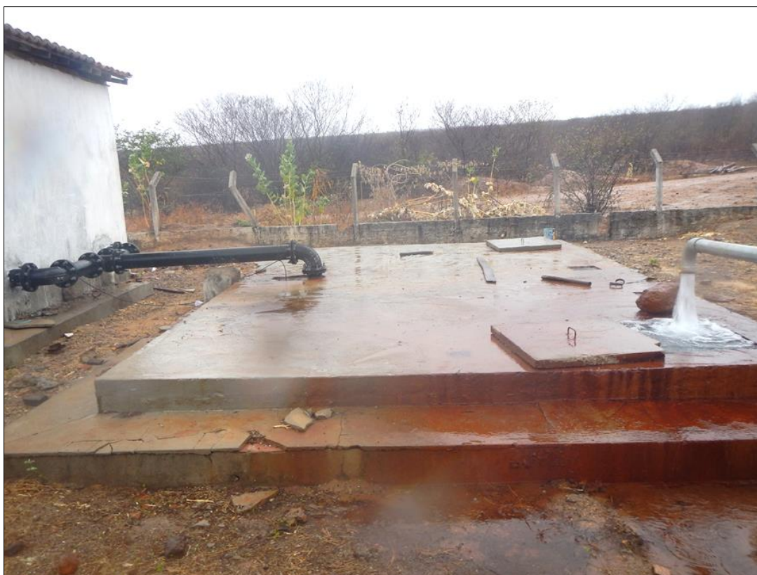
Foto 42: Reservatório tipo cisterna. Entrada de água na direita e saída para adutora na esquerda da imagem.
