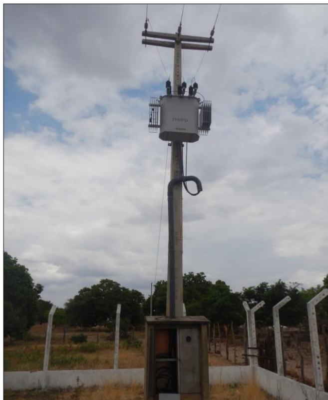
Foto 35: Transformador e rede elétrica no poço Lagoa do Canto. Não foi possível constatar se está operacional.
