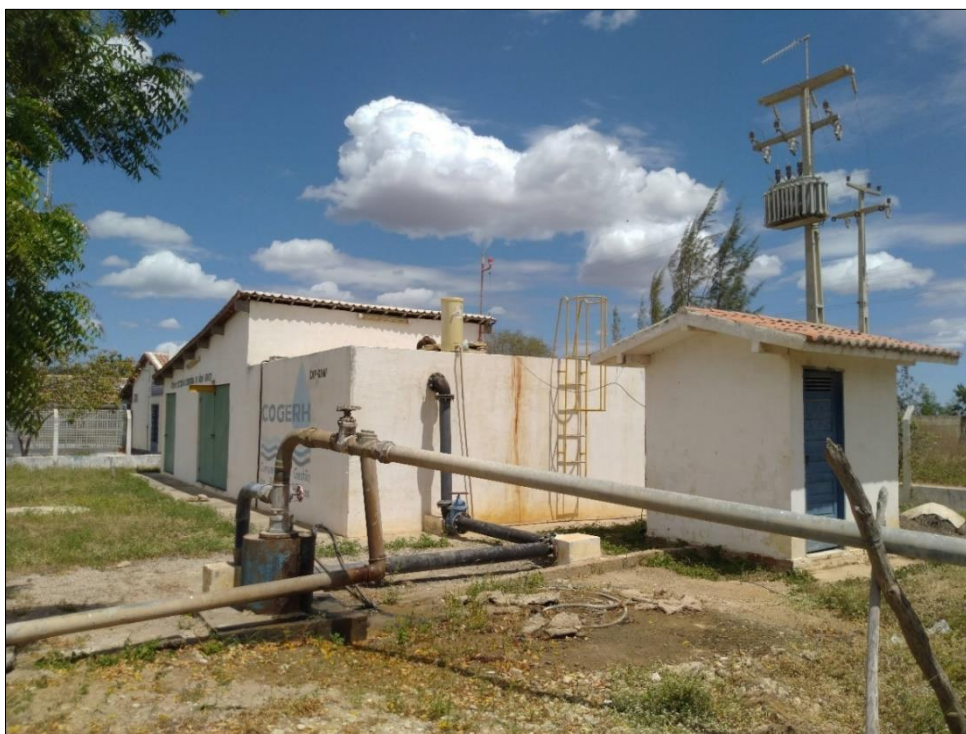
Foto 1: Poço SIAGAS - 2300023097 na comunidade Bom Sucesso, Quixeré - CE.
