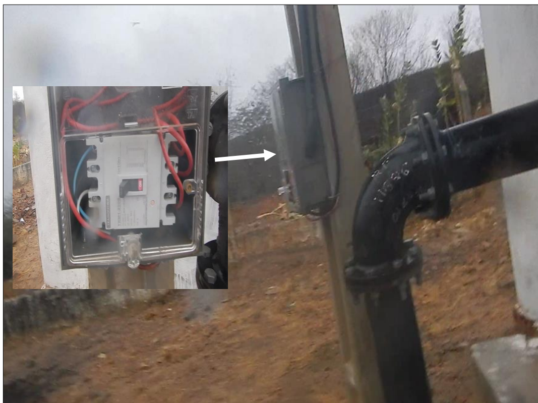
Foto 43: Detalhe da tubulação de saída da água para a adutora e do quadro de comando das bombas da adutora (fora da casa).
