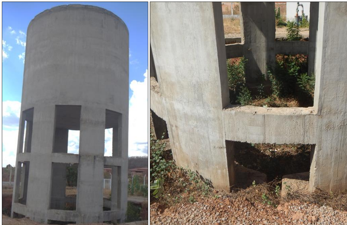
Foto 37: Detalhe do reservatório elevado com serviço de base inacabado.
