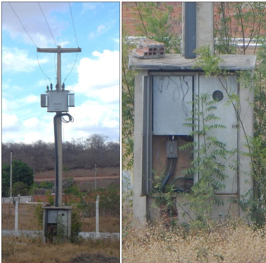
Foto 40: Transformador, rede elétrica e detalhe do quadro elétrico do poço Bairro Valdir Leite.
