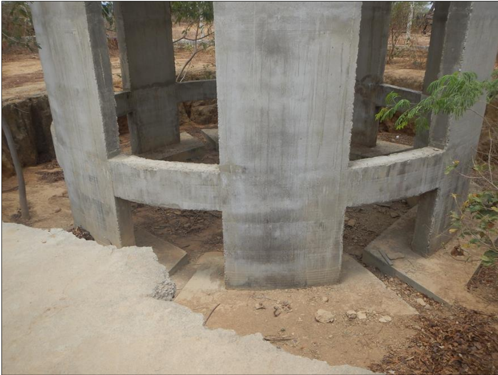
Foto 29: Base do reservatório - obra não finalizada.
