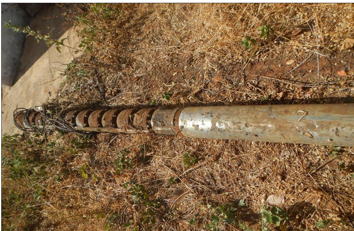
Foto 39: Bomba original do poço Bairro Valdir Leite abandonada na área cercada.
