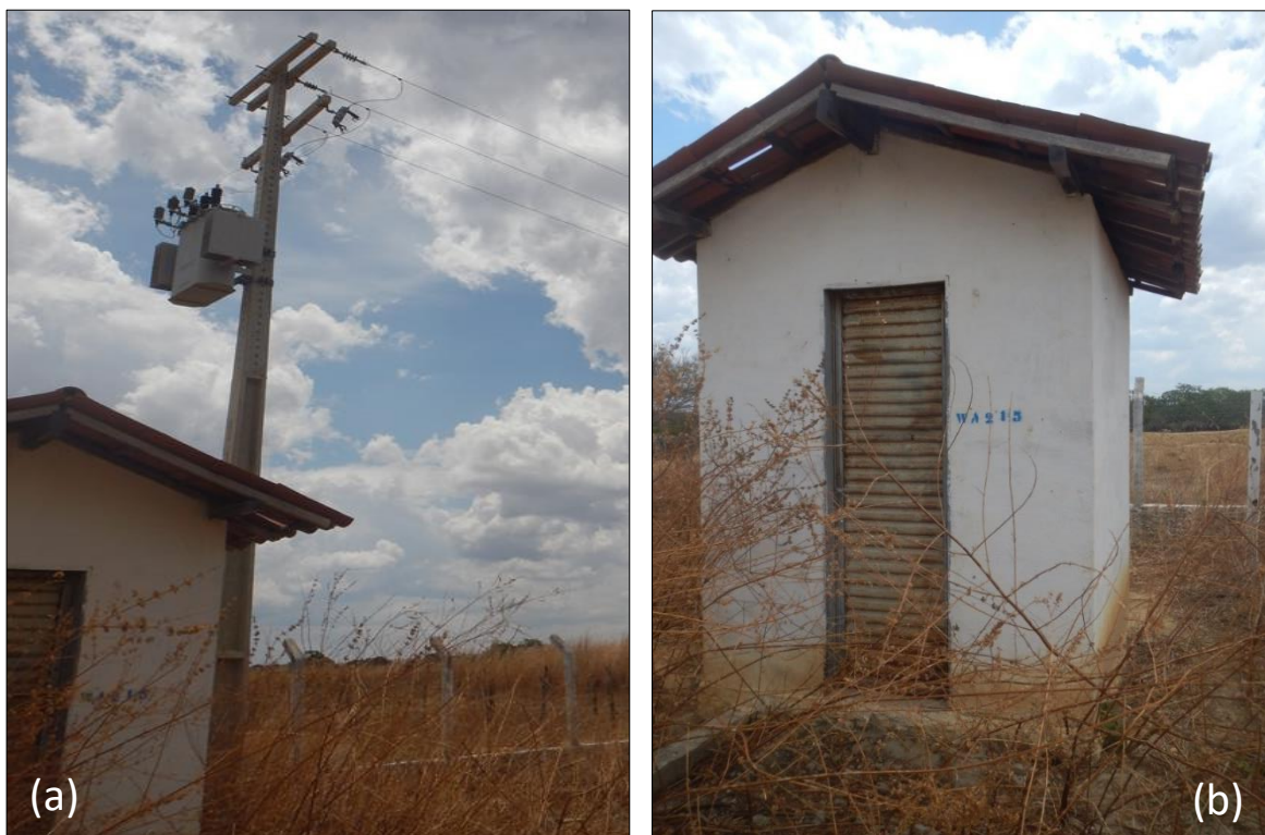
Foto 31: (a) Transformador e rede elétrica. Não foi possível identificar se está operacional; (b) Casa de comando da bomba – inacessível.
