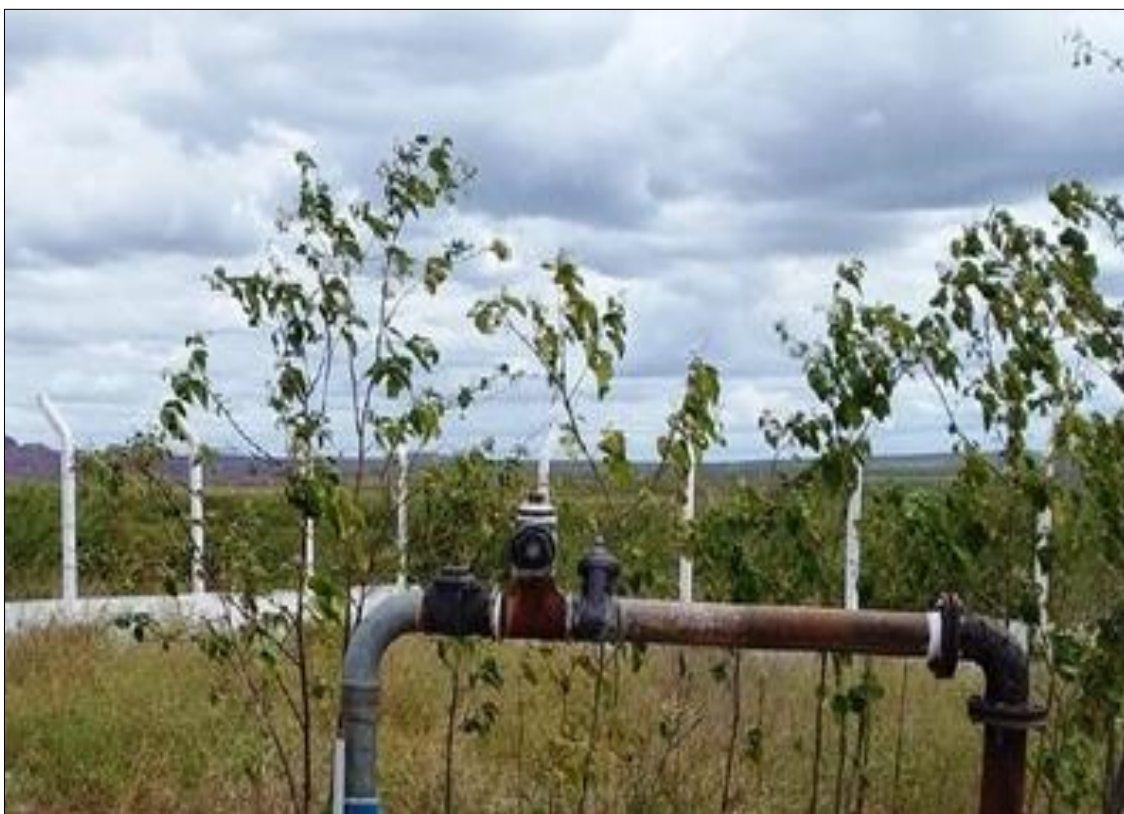
Foto 20: Estado de conservação do poço Califórnia, com presença de sinais de corrosão na tubulação do equipamento.
