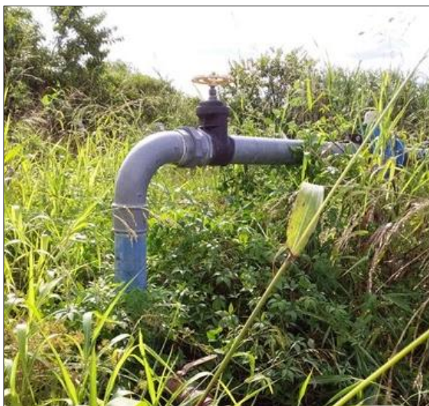
Foto 22: Estrutura de instalação do Poço Sítio Areias, Serra Talhada.
