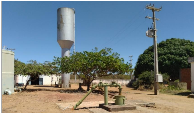
Foto 9: Poço SIAGAS - 2600005128, na Serra do Brejo, Bodocó, PE. COMPESA. Desativado.
