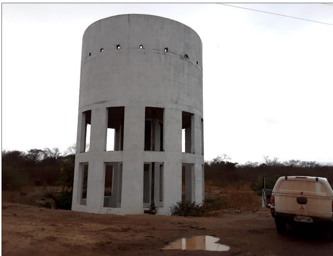
Foto 46: Reservatório do sistema da adutora entre o local do poço e a sede do município.
