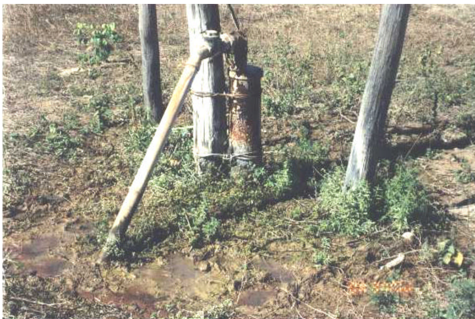
Foto 18 - Poço tubular em péssimo estado de conservação, sem laje de proteção e com vazamento de água. Nota-se acumulação de água residual doméstica ao redor do poço. Alto risco potencial de contaminação. Município de Francisco Sá.
