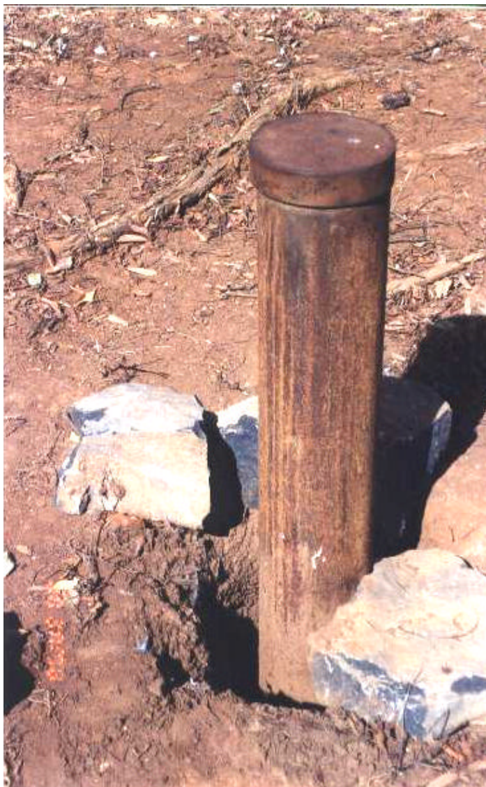
Foto 23 - Poço tubular com risco potencial de contaminação elevado, sem cimentação do espaço anelar e ausência de laje de proteção, facilitando o solapamento ao redor do revestimento. Município de Francisco Sá.
