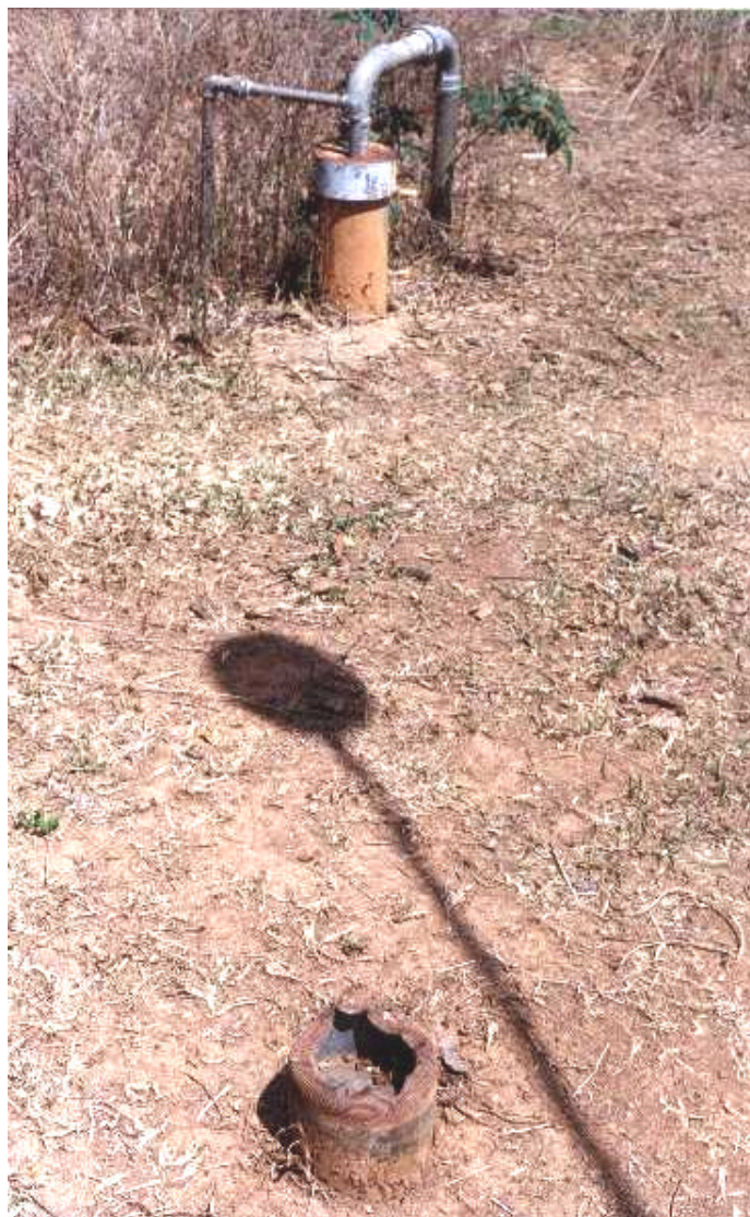
Foto 14 - Poço abandonado, na porção inferior da foto, mostrando ausência de tampa e laje de proteção sanitária, o que configura alto risco potencial de contaminação. Poço ativo, na porção superior da foto, sem laje de proteção sanitária.
