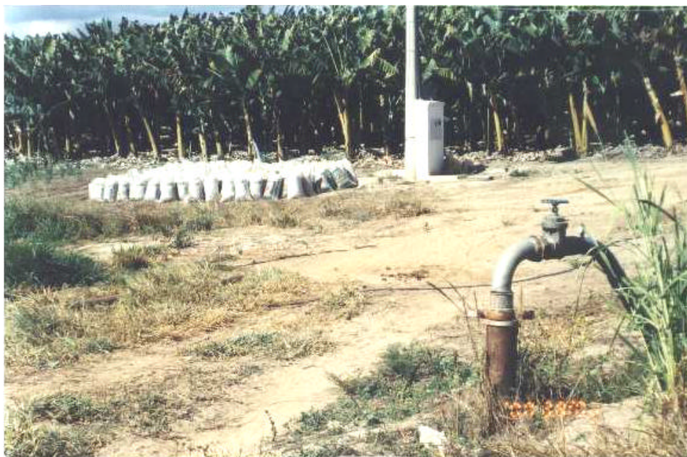
Foto 20 - Poço tubular sem laje de proteção sanitária, em área de irrigação de banana. Verifica-se o uso constante de fertilizante, o qual é armazenado próximo. Risco elevado de contaminação. Município de Francisco Sá.
