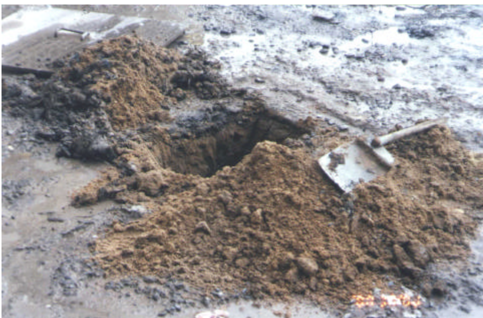
Foto 21 - Poço tubular com revestimento abaixo da superfície do terreno localizado em área de oficina mecânica e lavagem de automóveis. Encontra-se coberto com areia e sem laje de proteção. Alto risco de contaminação. Área urbana de Montes Claros.
