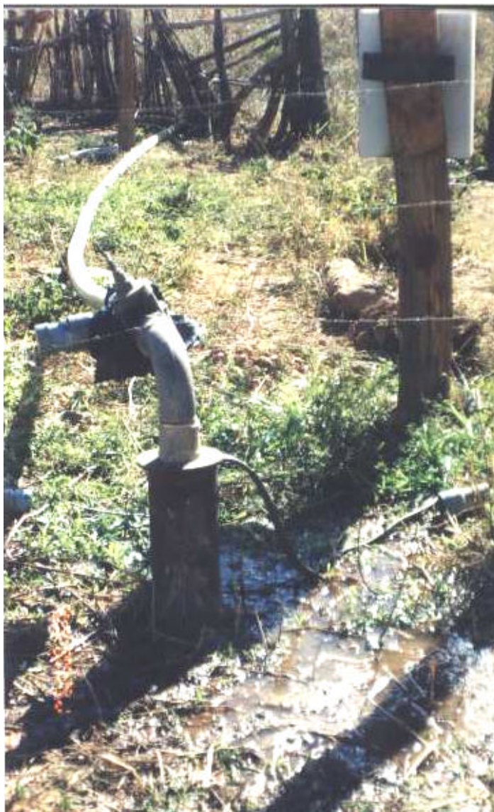
Foto 17 - Poço tubular em péssimo estado de conservação, sem laje de proteção, revestimento, furado, vazamento de água ao redor. Alto risco potencial de contaminação. Município de Francisco Sá.
