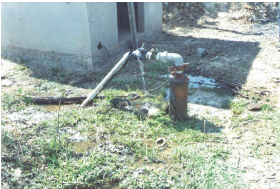
Foto 11 - Poço com vazamento na adução e ausência de laje de proteção sanitária, exibindo risco potencial médio de contaminação. Nota-se lama e estrume de gado próximo ao poço. Município de Lontra.
