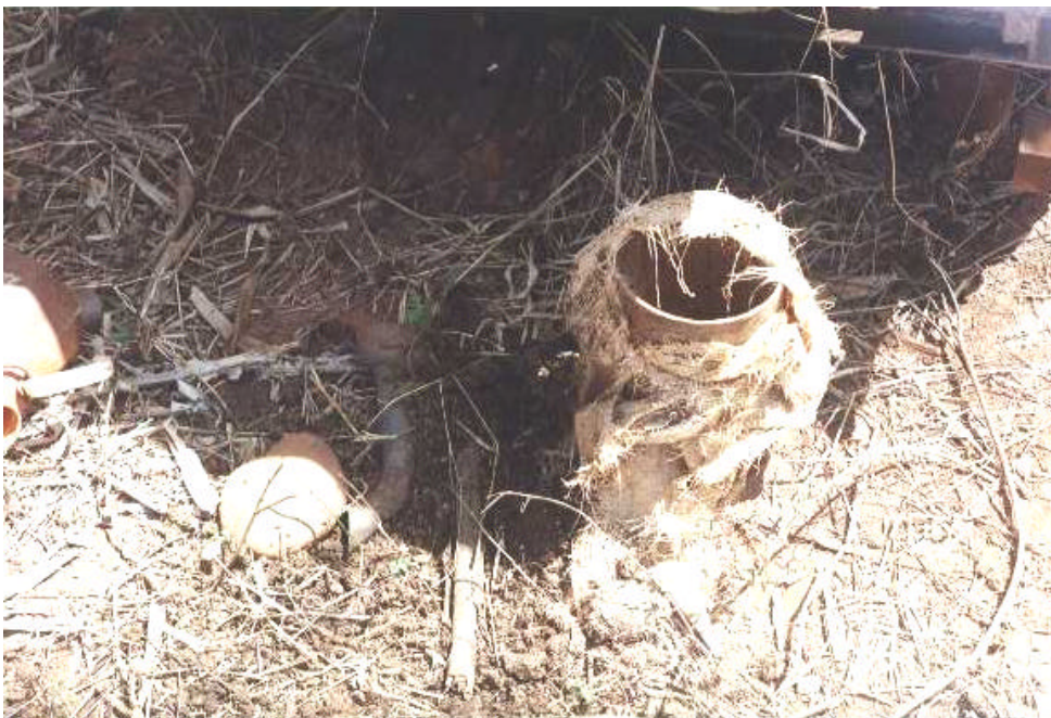
Foto 13 - Poço tubular abandonado, sem tampa, sem laje de proteção, configurando risco de contaminação. Município de Montes Claros.
