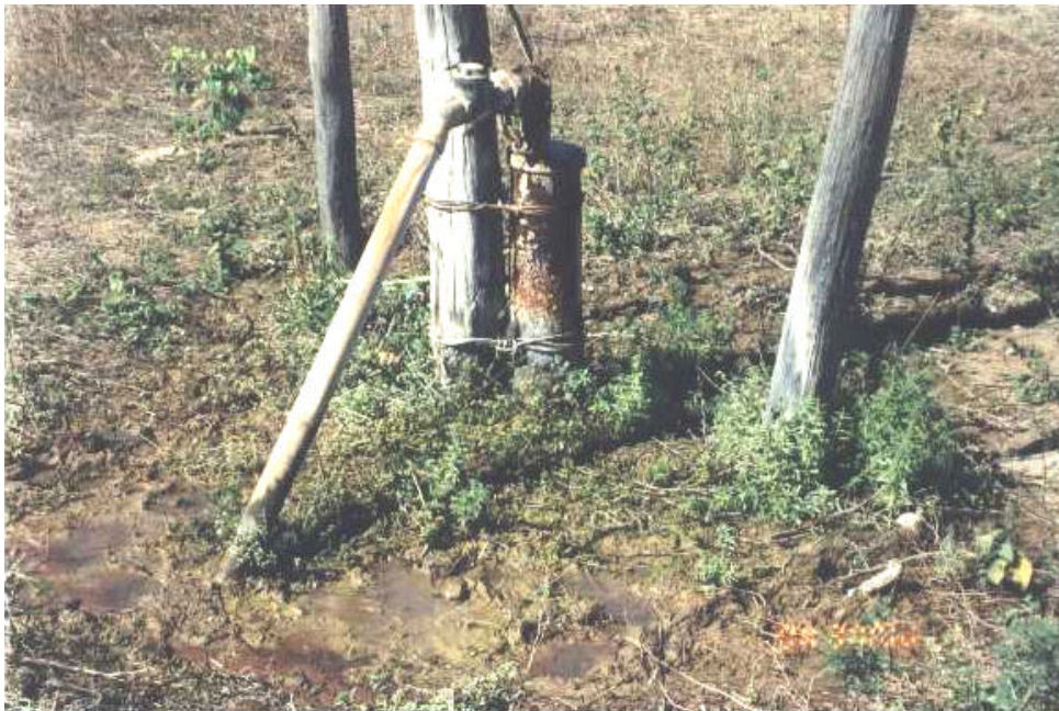
Foto 18 - Poço tubular em péssimo estado de conservação, sem laje de proteção e com vazamento de água. Nota-se acumulação de água residual doméstica ao redor do poço. Alto risco potencial de contaminação. Município de Francisco Sá.
