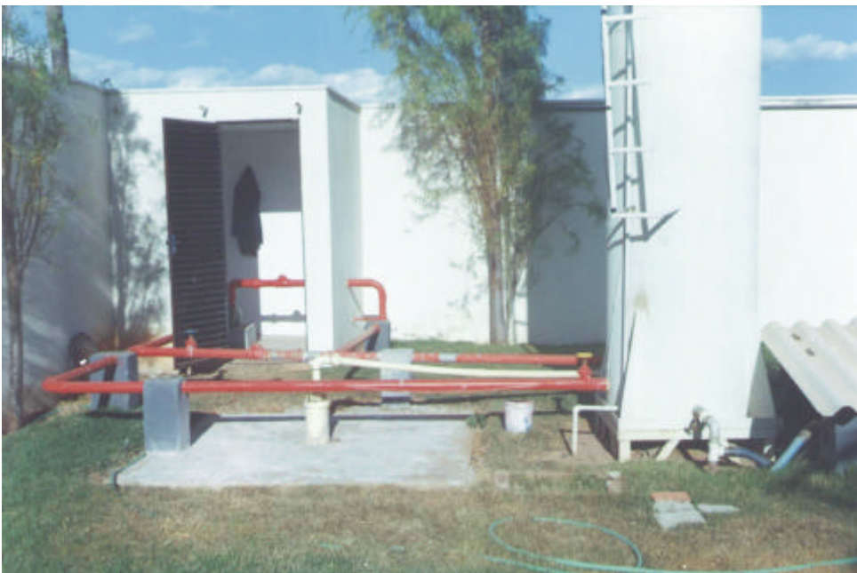
Foto 12 - Poço bem concluído, apresentando proteção sanitária maior que 1m 2 , reservatório e abrigo do painel elétrico em bom estado de conservação. Apresenta risco baixo de contaminação. Município de Montes Claros.
