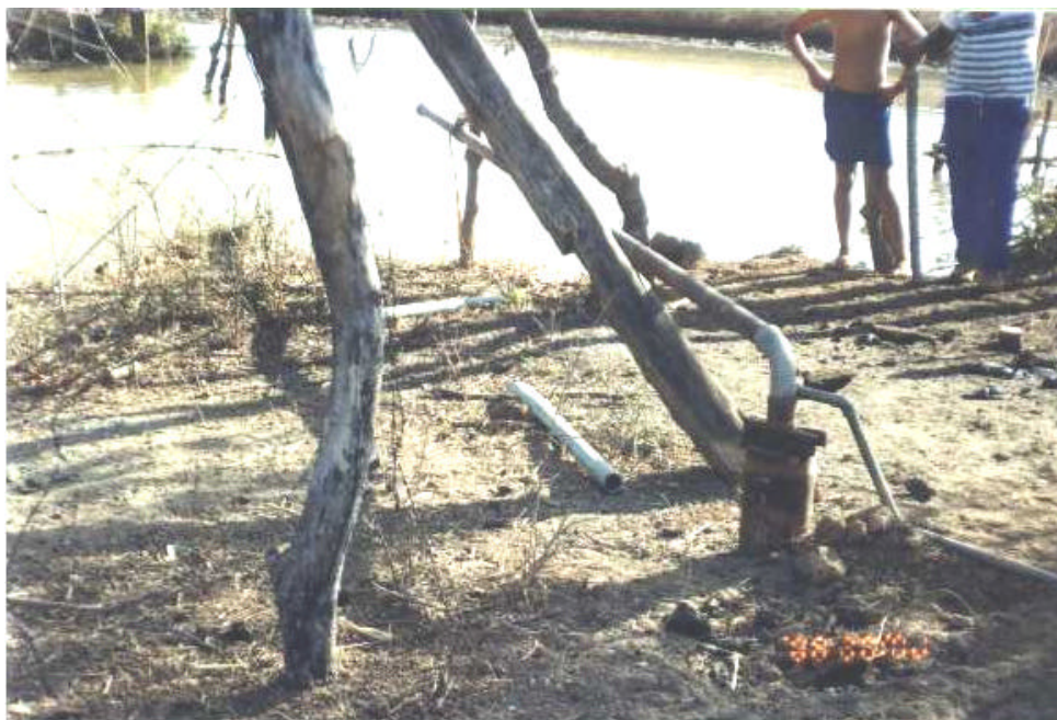
Foto 19 - Poço tubular sem laje de proteção e com risco de contaminação da água pelo vazamento de óleo do compressor. A água é bombeada e armazenada diretamente em escavação no solo, para dessedentação animal. Alto risco potencial de contaminação. Município de Francisco Sá.
