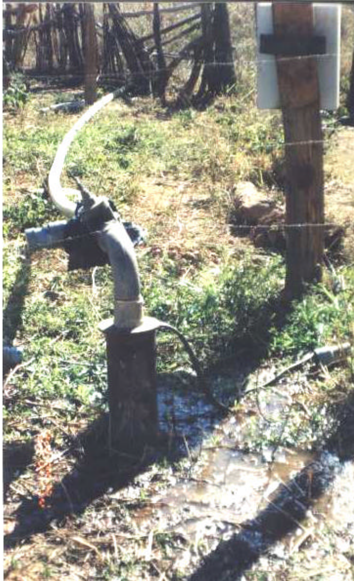
Foto 17 - Poço tubular em péssimo estado de conservação, sem laje de proteção, revestimento, furado, vazamento de água ao redor. Alto risco potencial de contaminação. Município de Francisco Sá.
