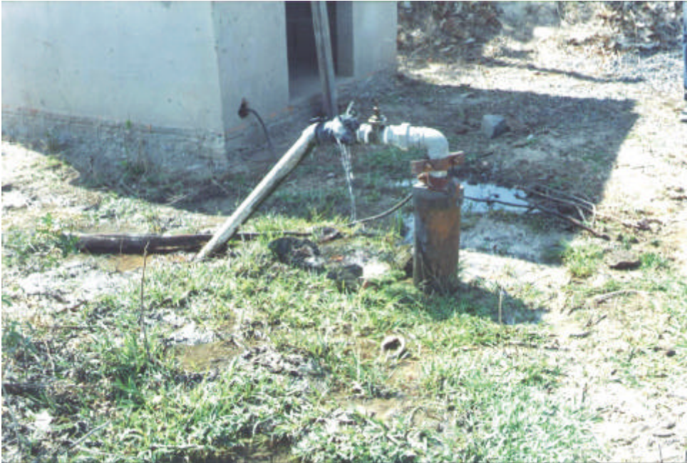
Foto 11 - Poço com vazamento na adução e ausência de laje de proteção sanitária, exibindo risco potencial médio de contaminação. Nota-se lama e estrume de gado próximo ao poço. Município de Lontra.
