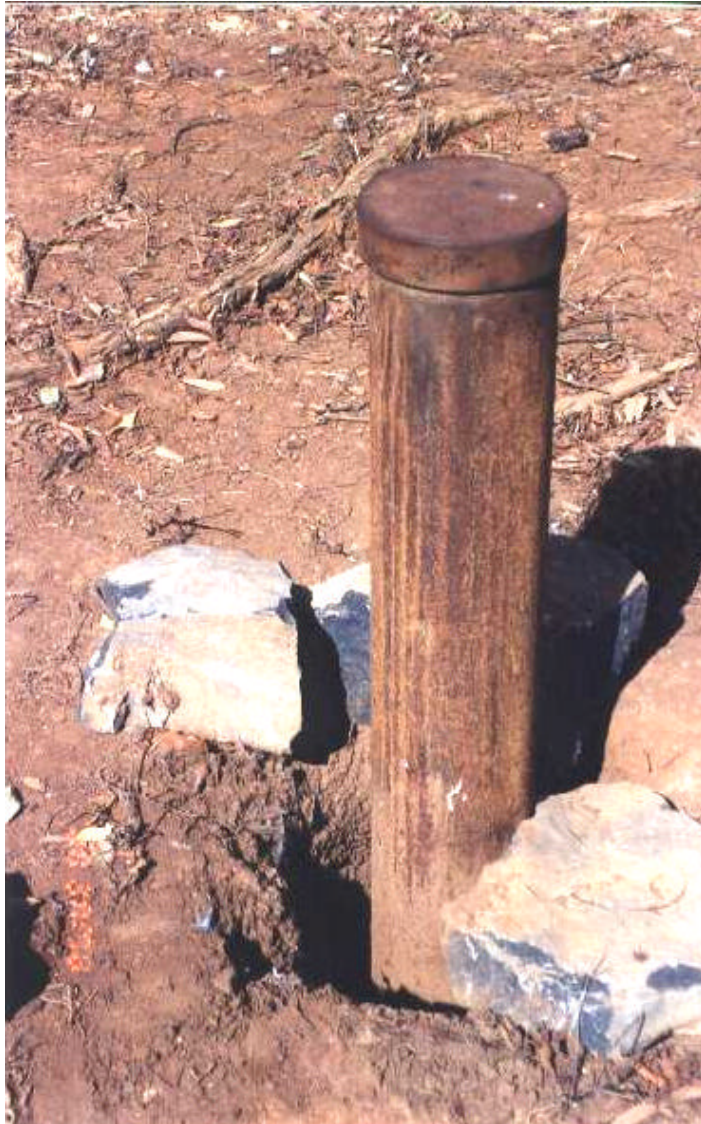
Foto 23 - Poço tubular com risco potencial de contaminação elevado, sem cimentação do espaço anelar e ausência de laje de proteção, facilitando o solapamento ao redor do revestimento. Município de Francisco Sá.
