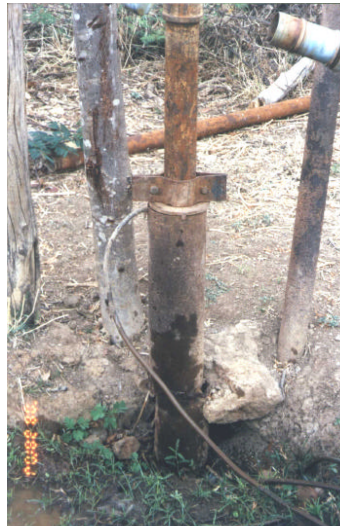
Foto 10 - Poço tubular em péssimo estado de conservação, e evidenciando alto risco potencial de contaminação, com revestimento enferrujado e furado, sem laje de proteção e solapamento junto ao revestimento. Município de Francisco Sá.
