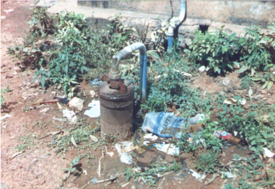
Foto 16 - Poço apresentando risco potencial muito alto de contaminação, decorrente de orifício no revestimento próximo à superfície do terreno e da ausência de laje de proteção sanitária. Nota-se o acúmulo de lixo doméstico em torno da saliência do poço e vazamento de água na adução. Município de Brasília de Minas.
