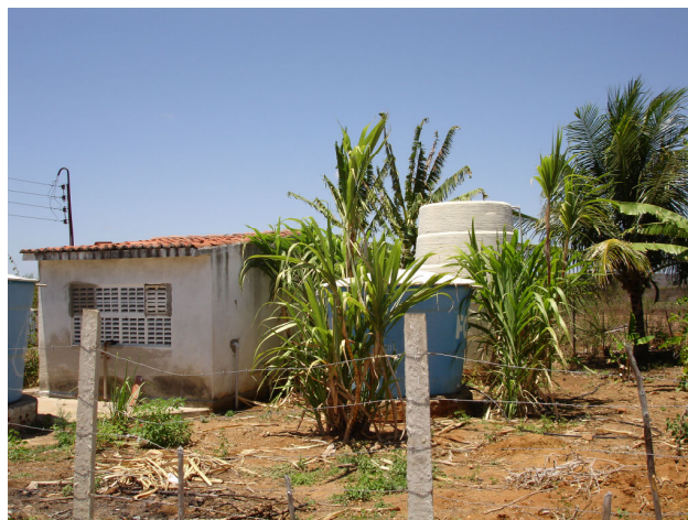
Figura 2.33 – Local onde está instalado o dessalinizador que fornece água para o povoado de Carolina.
