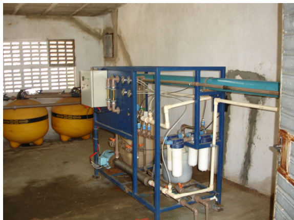
Figura 2.34 – Aspectos do equipamento de dessalinização instalado.
