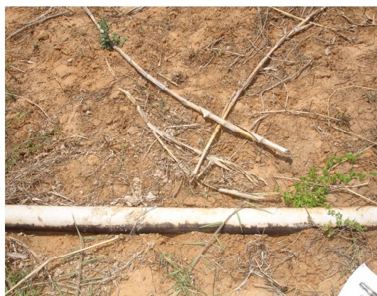
Figura 2.25A – Tubulação da adutora Roca Velhas
