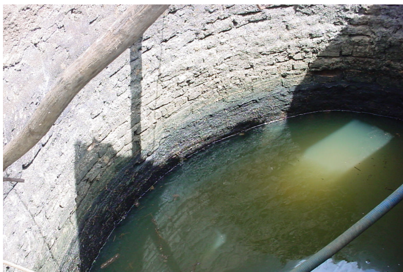
Figura 4.25 - Fonte de abastecimento encontrada na comunidade
