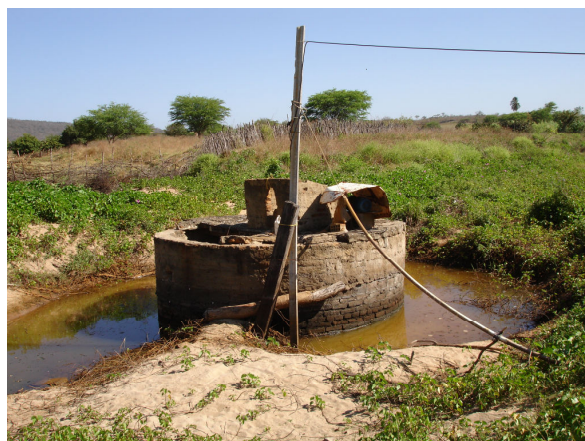
Figura 2.28 – Poço amazonas (P32-C8), equipado com bomba centrífuga, que abastece o povoado do Ingá. Observa-se a aluvião saturada
