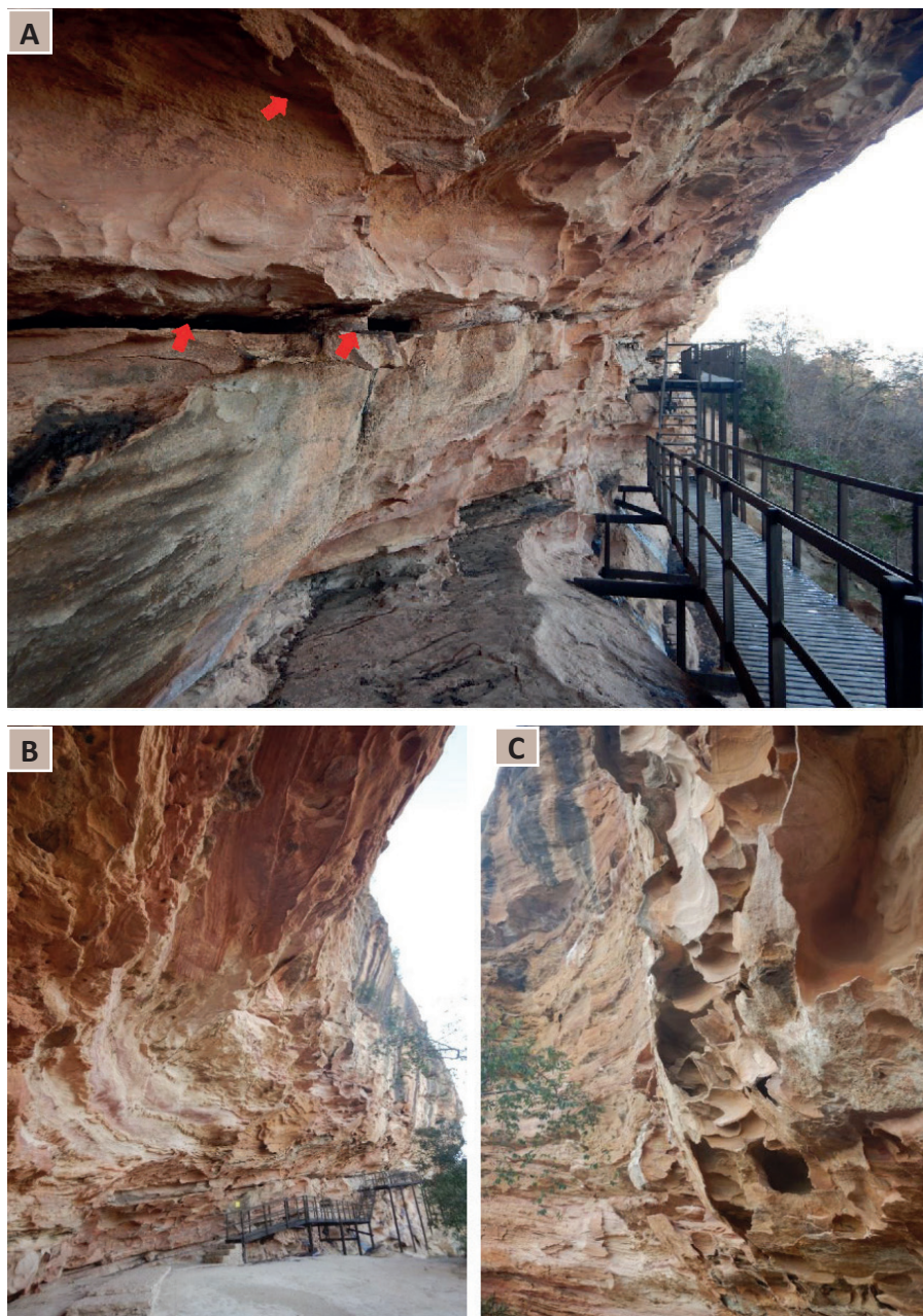
Figura 40 - Feições de fragilidade do maciço rochosos que gera riscos de quedas e desprendimento de blocos diante da forte ação das águas meteóricas com formação de nichos e alvéolos (a, c), erosão ao longo do contato arenito-siltito (a), presença de blocos em balanço (a, b), cicatrizes de quedas de blocos (a, b) e marcas de forte escorrência da água do topo à base do maciço (b). Foto: Autores (2023).
