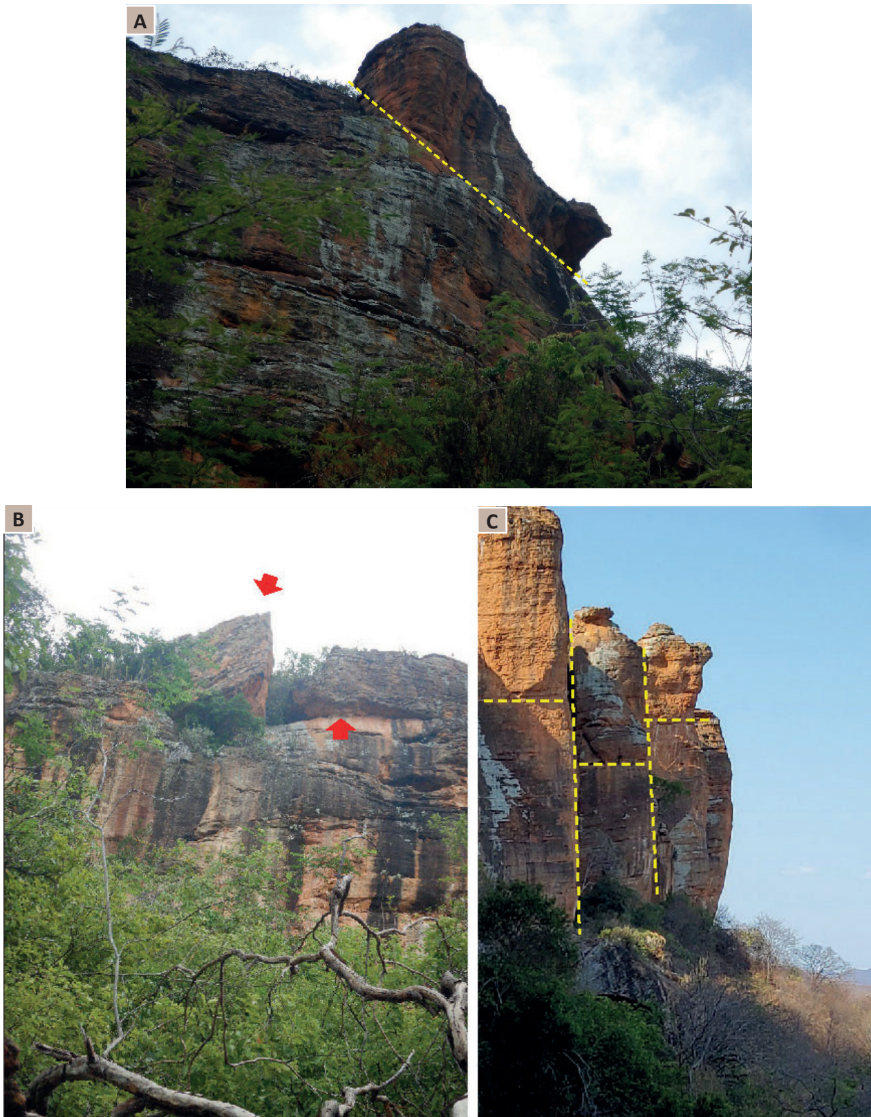
Figura 53 - Situações de forte controle tectônico e de erosão hídrica na borda da serra: descontinuidade (seta amarela traço ponto) individualizando e instabilizando bloco com risco de queda (a); bloco que se desprende do maciço em posição atual de risco e sinal de cicatriz de queda de bloco (b); grandes blocos na forma de torres em situação de instabilidade para tombamento (c). Foto Autores (2023).
