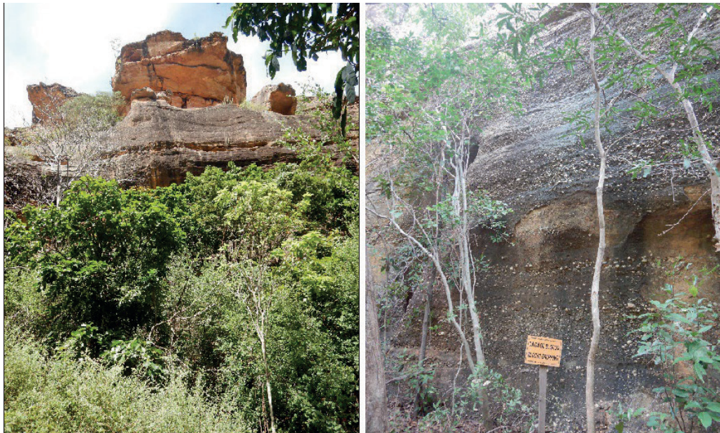
Figura 64 - Vista dos paredões laterais que delimitam o cânion de acesso à Toca do Baixão da Vaca, com destaque para os riscos de quedas de blocos. Foto: Autores (2023).
