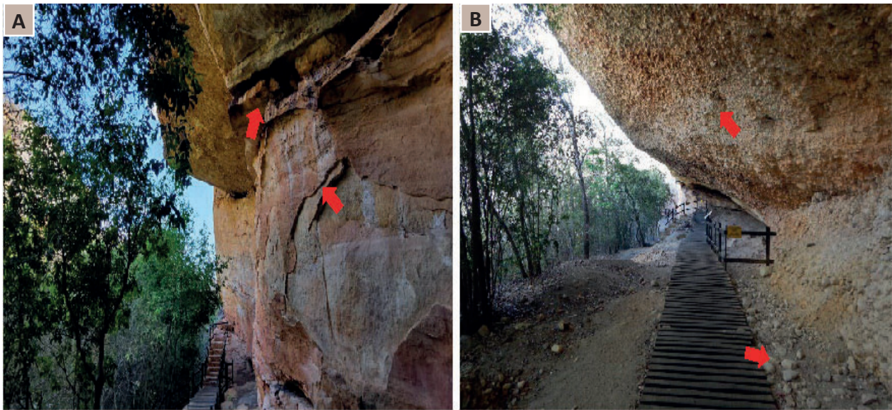
Figura 62 - Vista geral do abrigo com exposição do arenito (a) e conglomerado grosseiro (b) da Formação Ipu com indicativos de quedas de blocos, deslocamento e desprendimento de seixos (a, b) configurando situações de risco. Foto: Autores (2023).
