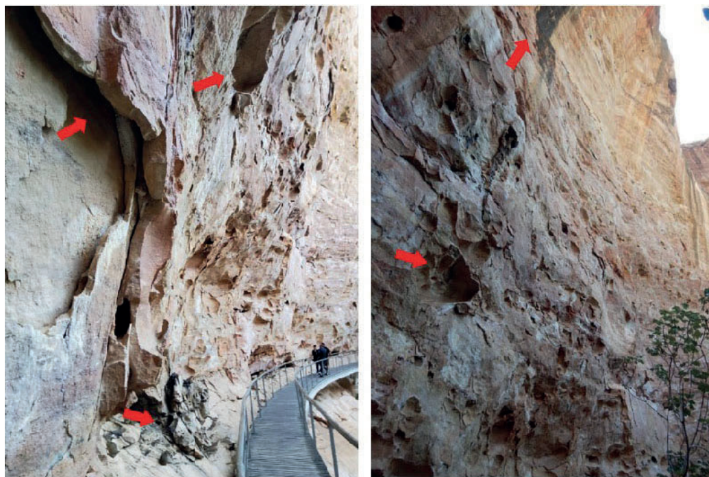
Figura 17 - Paredões verticalizados evidenciando a ação dos agentes externos, água, vento e temperatura, na instabilização localizada do maciço rochoso. As imagens mostram pontos de fragilidade do maciço: deslocamento/esfoliação; blocos instáveis e nichos e ação da água ao escorrer sobre a encosta. Foto: Autores, 2023.
