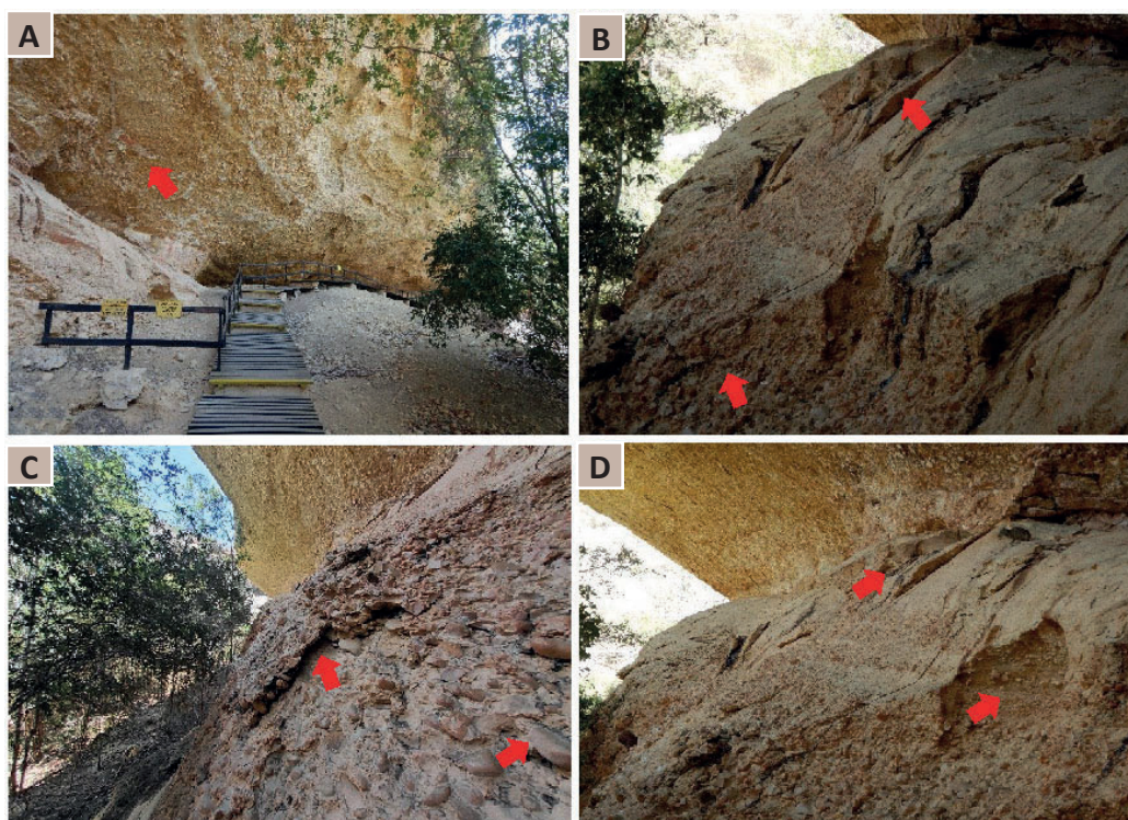
Figura 38 - Paredões íngremes com forte tendência a desprendimento de seixos (a, b, c, d), queda de blocos instáveis (a, d) e deslizamento de blocos conglomeráticos instabilizados pelo processo de esfoliação (c). Foto: Autores (2023).
