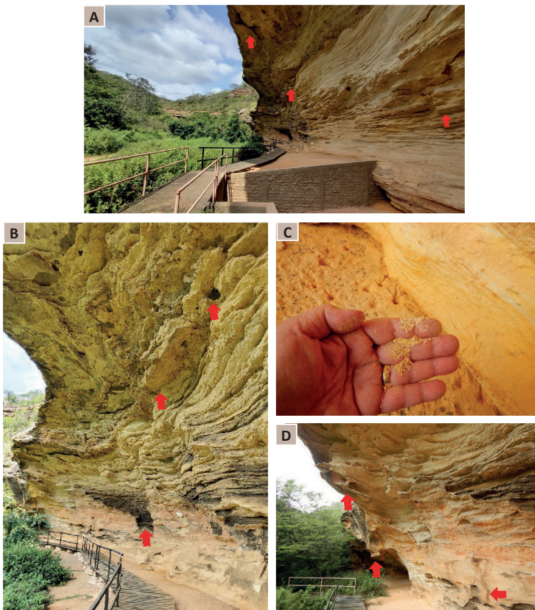
Figura 80 - Feições de desagregação do maciço rochoso pelos agentes externos com risco alto de quedas de blocos (a, b, d), deslocamento (d) e blocos em balanço (b, d), material fino desagregado da rocha por ação do vento ©. Foto: Autores (2023).
