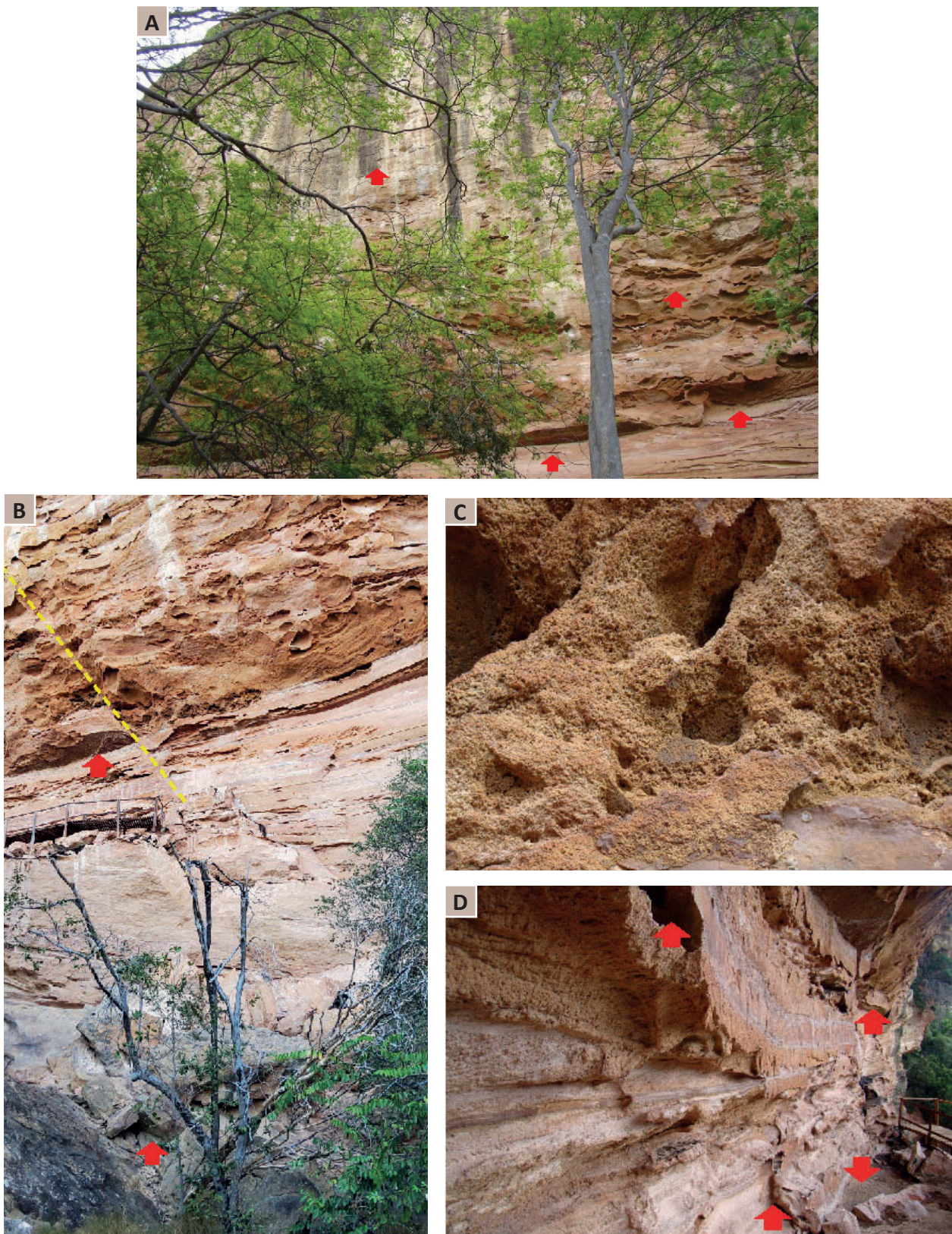
Figura 54 - Encosta com escoamento de água pluvial pela porção frontal da encosta, com formação de nichos (a) e presença de diáclase (b), cicatriz de queda de bloco e muitos blocos caídos e em situação de risco por tombamento eminente (b, d); formação de crosta e subsequente deslocamento (d); arenito friável sob forte ação da erosão em processo de arenização (c). Foto: Autores (2023).
