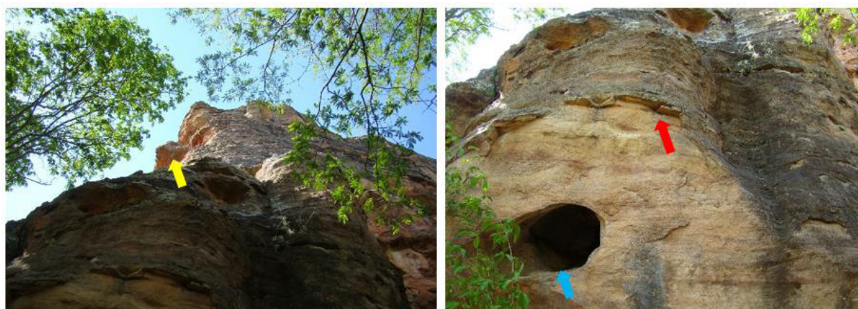
Figura 30 - Cicatrizes de quedas de blocos (setas amarelas), blocos em balanço (setas vermelhas) e dutos externos (seta azul) como indicativos dos efeitos instabilizadores dos agentes de intemperismo externos em ação conjunta com a temperatura ao deslocar a rocha com sinais da movimentação de massa e risco ao longo do maciço rochoso. Foto: Autores (2023).
