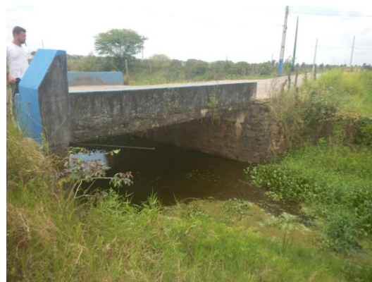
Figura 6 – Ponte com aparente sub-dimensionamento de vão mediante a volume d'água que circula em períodos de chuva.
