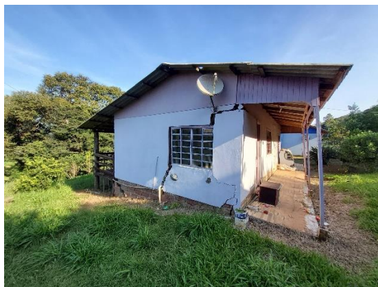
Figura 14 – Casa destruída pela movimentação.
