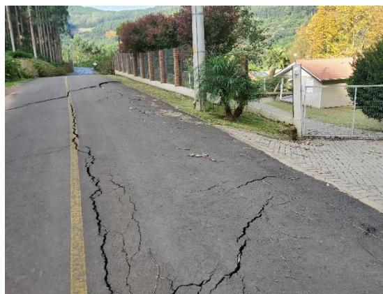
Figura 18 – Trincas e degraus próximo a uma residência.
