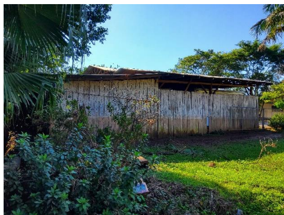
Figura 6 – Marca d'água indicando a cota de inundação na parede da edificação.
