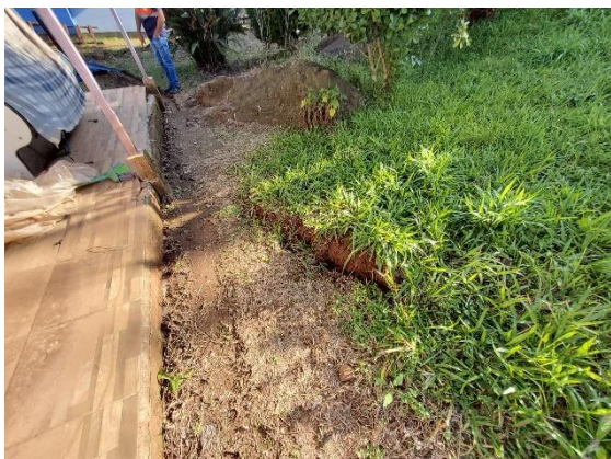
Figura 13 – Degrão de abatimento.
