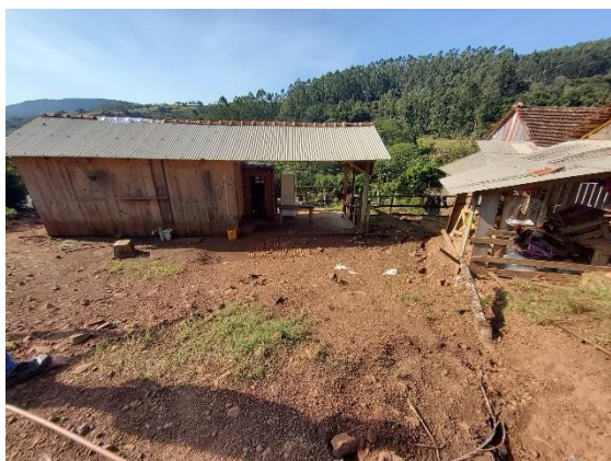
Figura 9 – Casas de madeira e trincas no terreno.
