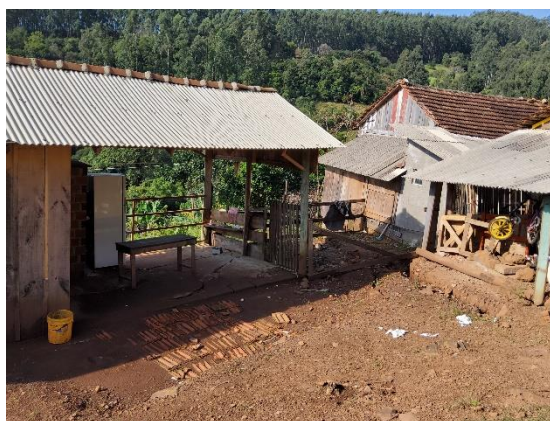
Figura 10 – Degrau de abatimento próximo a casa.
